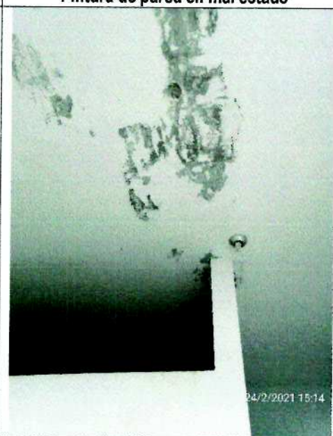
Pintura de pared en mal estado
