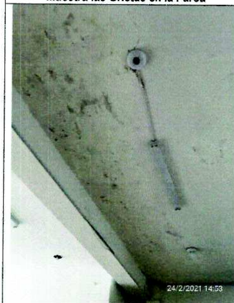
Muestra las Grietas en la Pared
