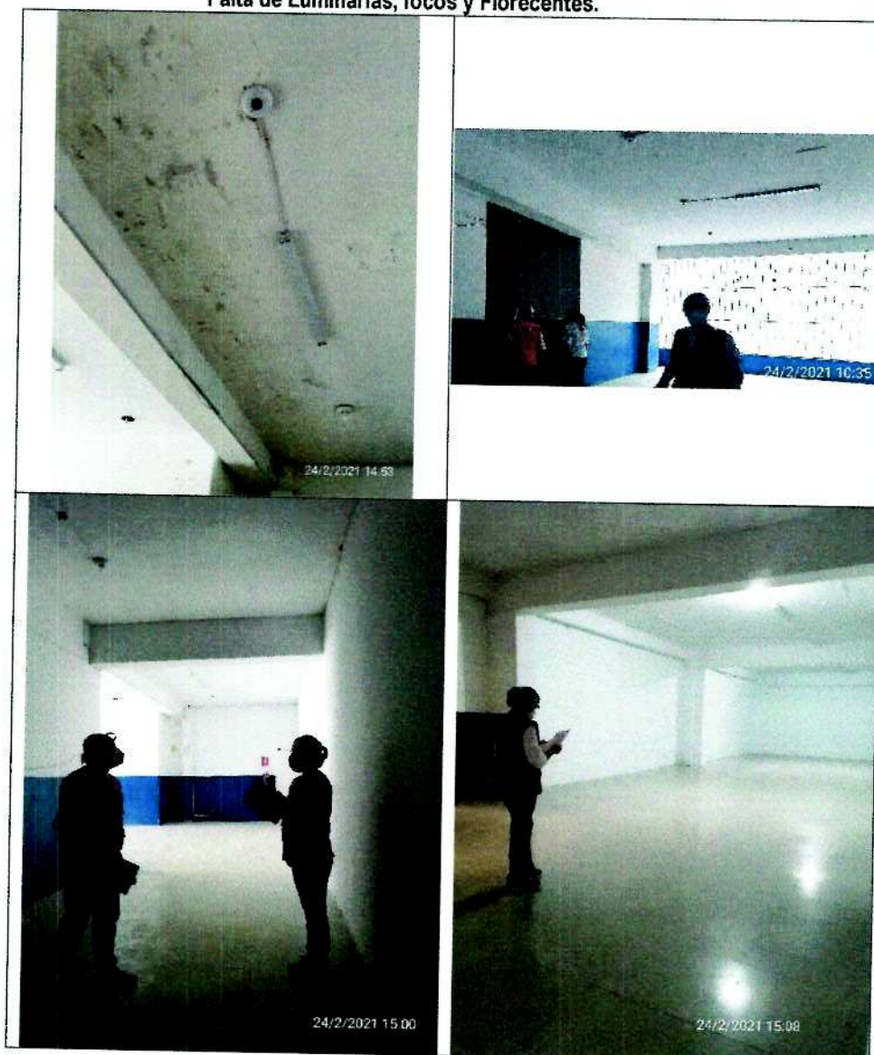
Imagen n° 8 Falta de Luminarias, focos y Florecentes.
