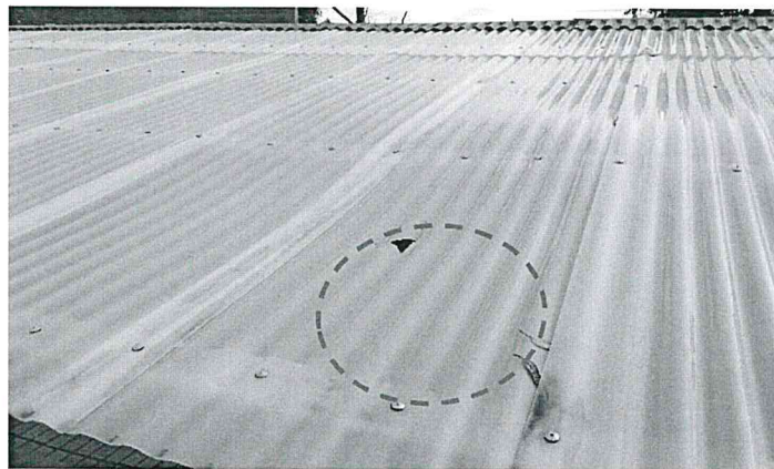
En la imagen n.º 21, se observa rotura de la calamina del lecho de secado de la PTAR..
