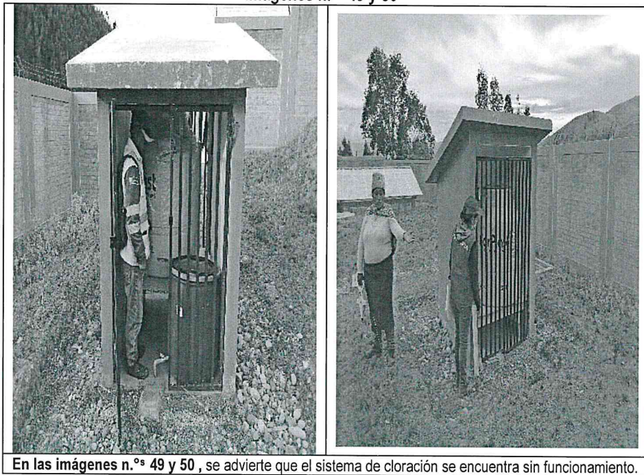
Sistema de Cloración del PTAR de Colpar Imágenes n.ºs 49 y 50
