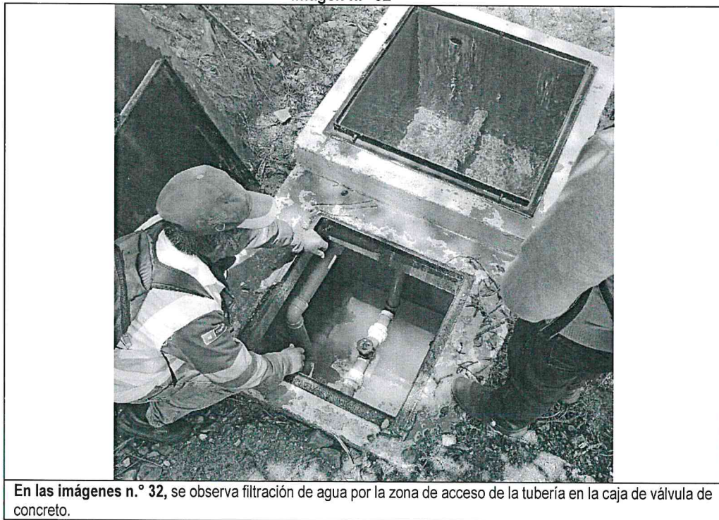
Cámara rompe presión Imágen n.º 32
