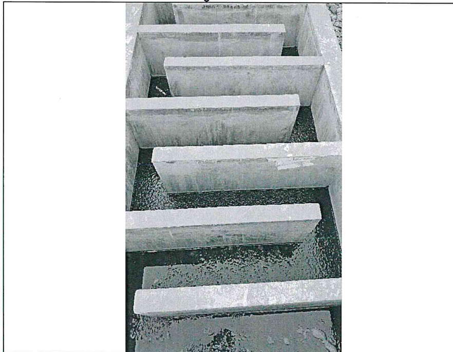
En la imagen n.º 24, se observa el desprendimiento de pintura.
