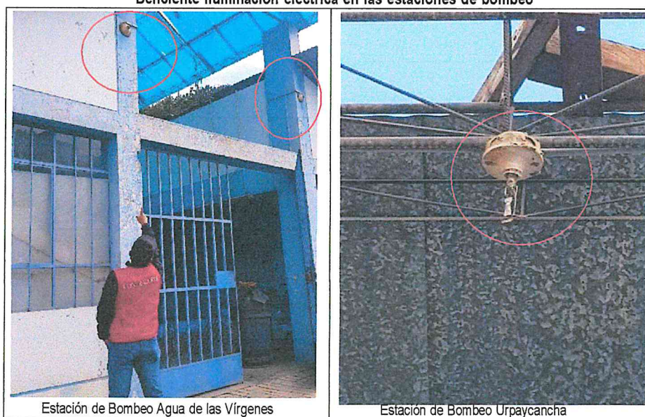
Imagen n. ° 7 Deficiente iluminación eléctrica en las estaciones de bombeo
