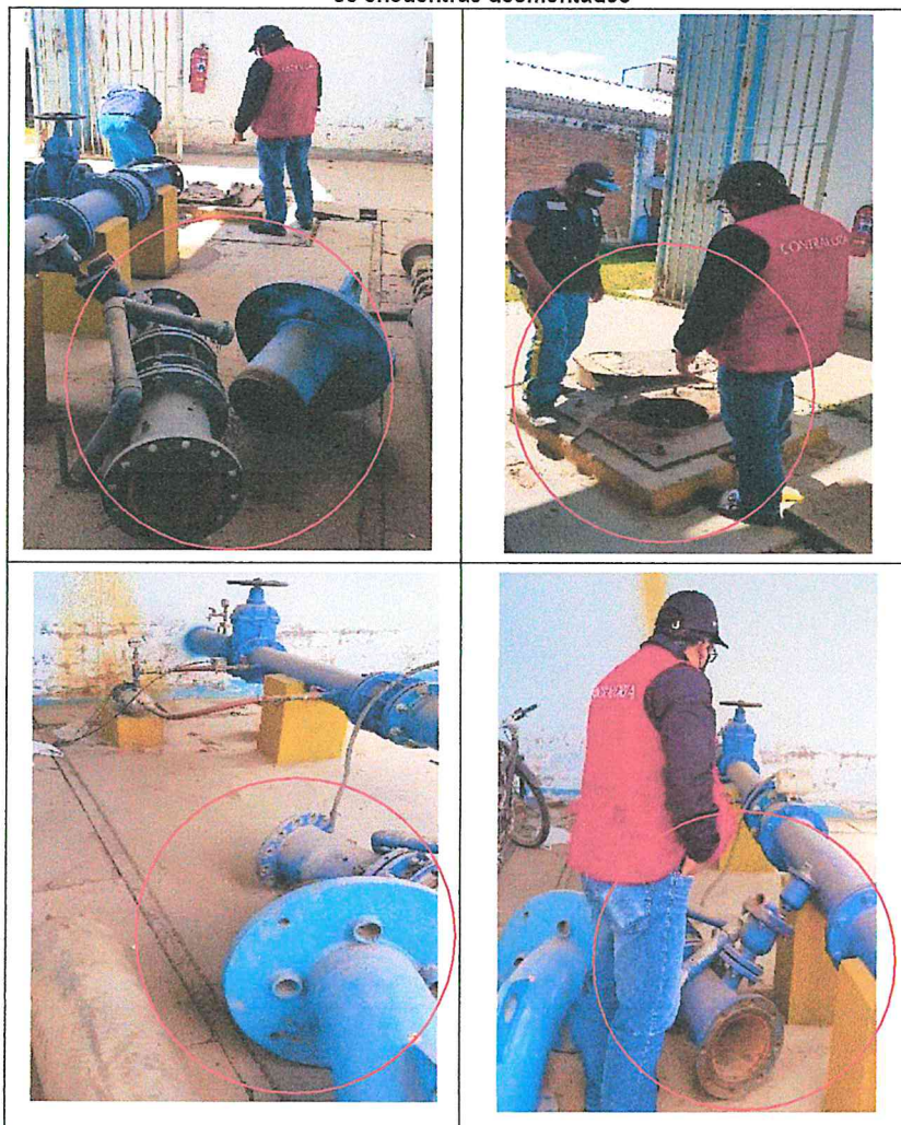
Imagen n.º 4 Estación de bombeo Azapampa inoperativo, los equipos y accesorios se encuentran desmontados
