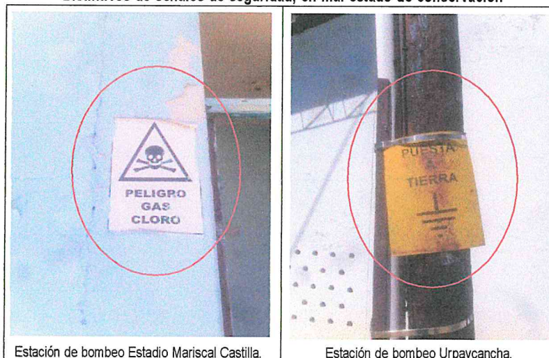
Imagen n. ° 8 Distintivos de señales de seguridad, en mal estado de conservación
