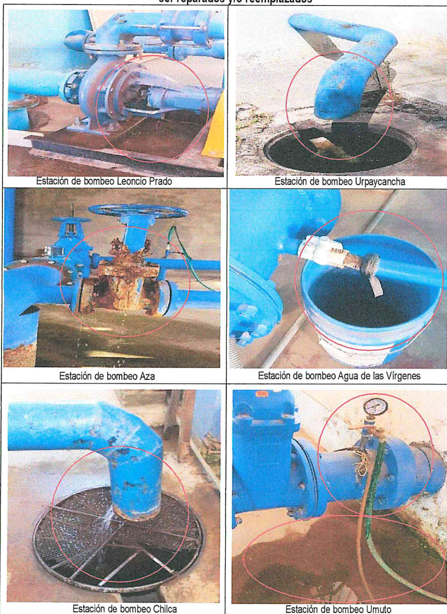
Imagen n.º 3 Accesorios instalados en las distintas estaciones de bombeo que requieren ser reparados y/o reemplazados
