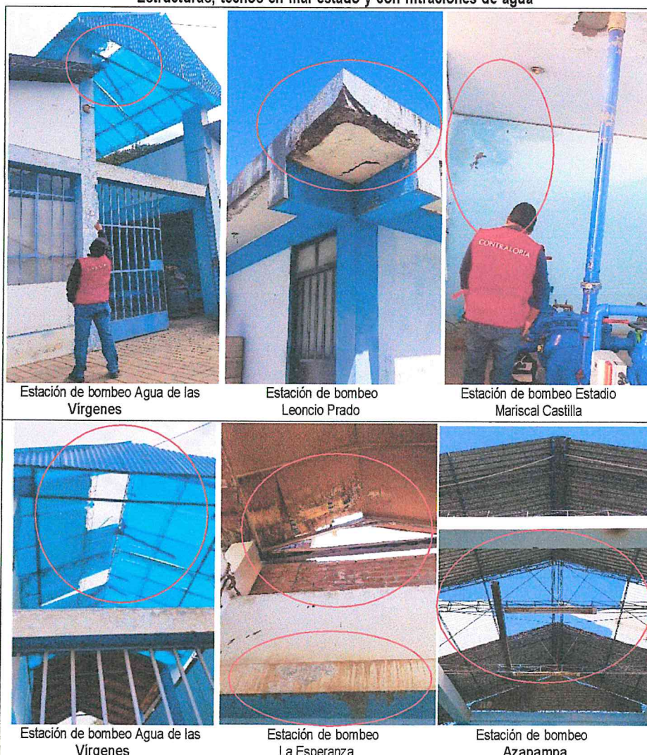
Imagen n.º 6 Estructuras, techos en mal estado y con filtraciones de agua
