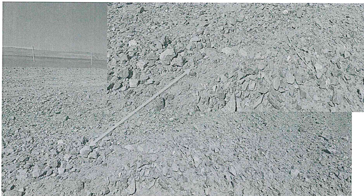
Imagen n.º 4 Piedras sobre superficie de rodadura del camino vecinal
