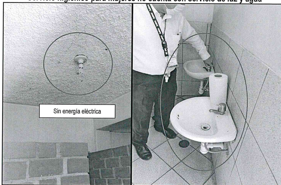
Imagen n.º 17 Servicio higiénico para mujeres no cuenta con servicio de luz y agua
