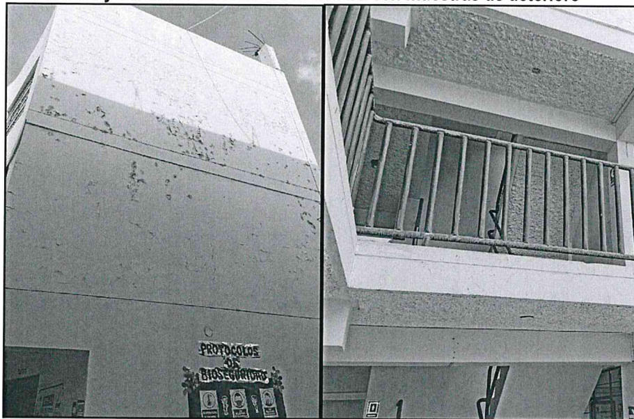
Imagen n.º 7 Paredes y barandas del local de ODPE Ica con muestras de deterioro
