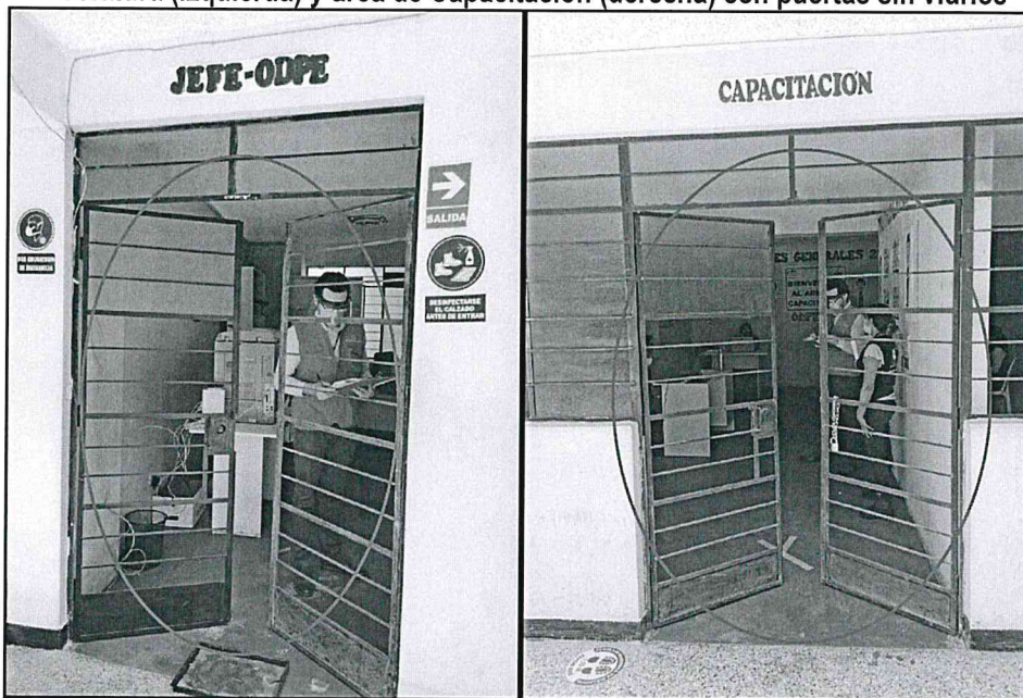
Imagen n.º 15 Jefatura (izquierda) y área de Capacitación (derecha) con puertas sin vidrios
