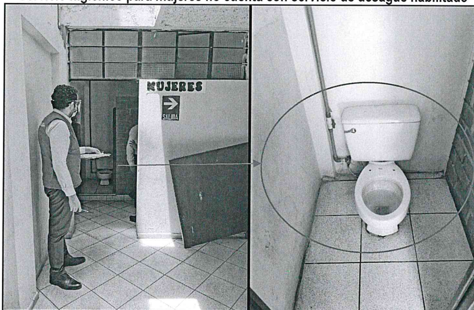
Imagen n.º 16 Servicio higiénico para mujeres no cuenta con servicio de desagüe habilitado
