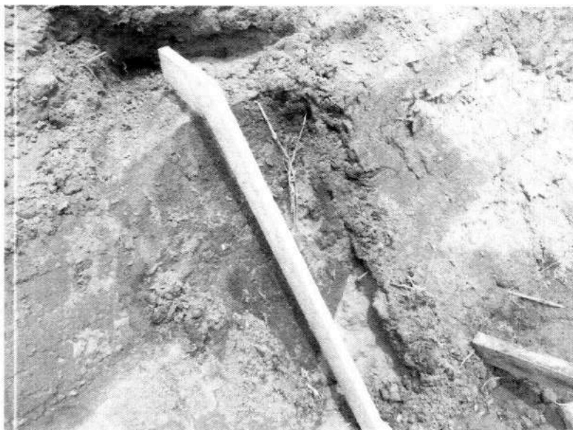
Talud con presencia de tierra agrícola y también se ve la existencia de raíces en el canal de riego Clake. [...].
