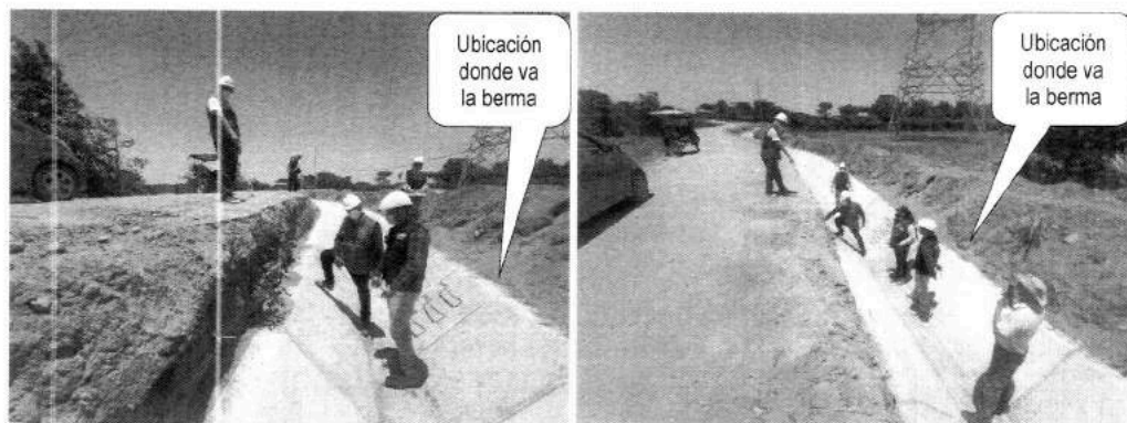
Imagen n.º 21: Se verifico que no existe ningún trabajo desarrollado sobre conformación de bermas y afirmado
