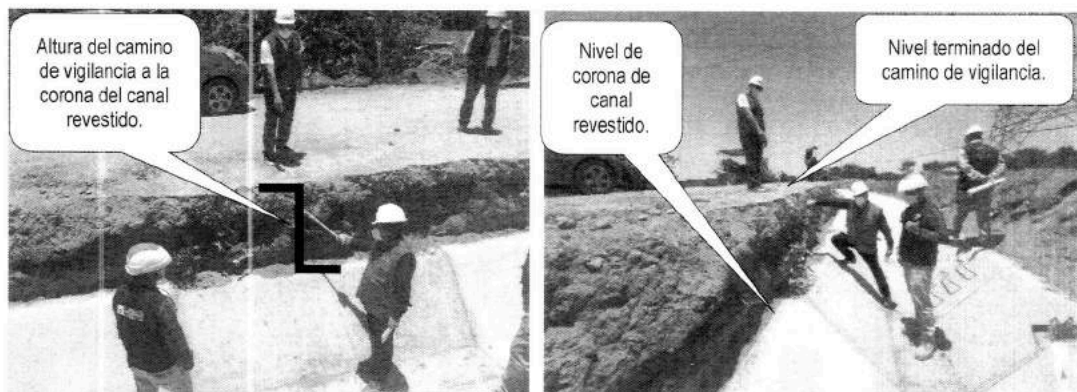
Imagen n.º 04: Verificando en el canal Clake, la altura que existe desde el nivel terminado del punto de corona del canal revestido hasta el nivel terminado del camino de vigilancia.
