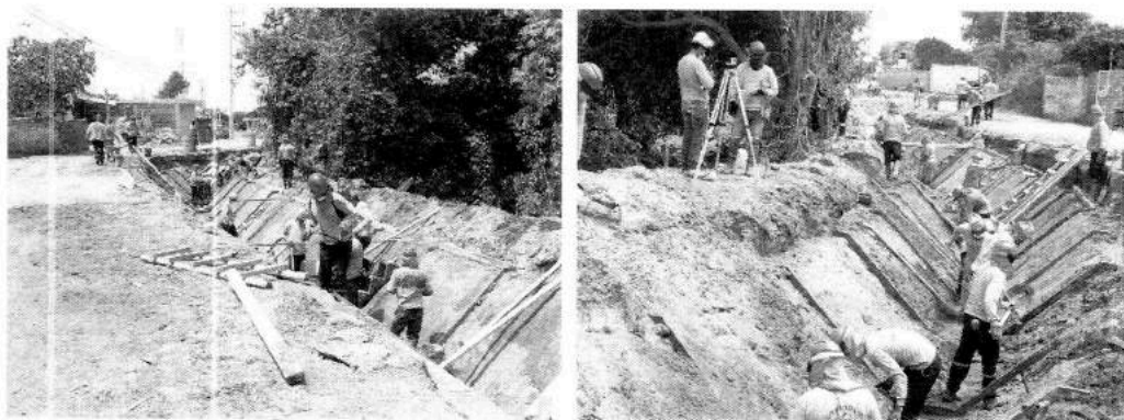
Personal realizando labores de perfilado y refine de caja de canal de riego Reque Tramo C.
