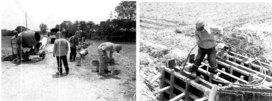
Imagen n.º 18: Verificando en el canal de riego Clake la construcción de una Toma Predial (Obra de arte) en el KM 0 + 335, observándose que en el vaciado de concreto no se viene empleando el Minicargador bobcat 70 HP, 0.5 Yd 3 y el Concreto Premezclado F’c=210 Kg/cm 2 .
