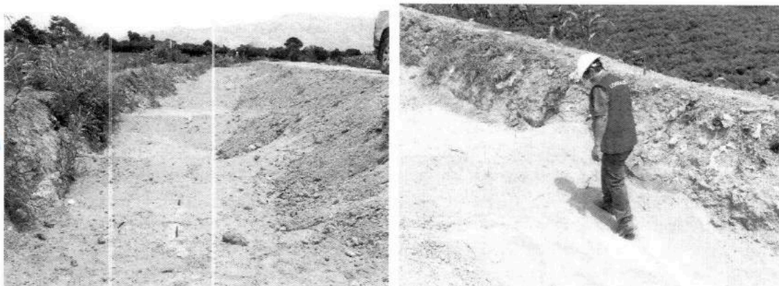
Tramo de canal de riego Magnal, el cual se encuentra en la fase de relleno compactado de caja de canal. Sin embargo, de la verificación realizada se puede manifestar que existen indicios que no está compactado ya que a simple vista se muestra arena suelta donde las pisadas del calzado se hunden.
