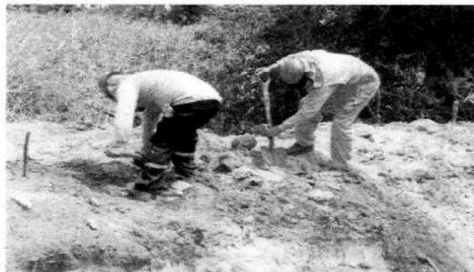
Se observa 2 peones utilizando material contaminado (presencia de raíces, piedras y tierra agrícola) para realizar el relleno, refine y perfilado de los taludes de la caja hidráulica del canal de riego Reque Tramo C.
