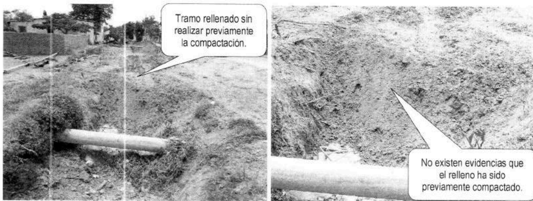
Imagen n.º 07: En el canal de riego Reque Tramo C, se puede observar que el material de relleno de la caja del canal se viene colocando dentro del canal excavado el cual no está compactado y libre de escombros y vegetación.
