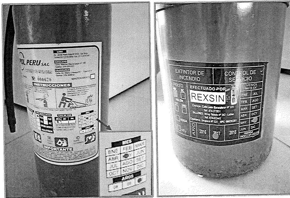
Fotografías 3, 4 y 5: Extintores del cuarto frío del almacén de vacunas.
