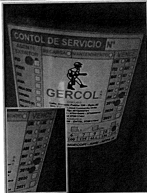
Fotografías 14, 15 y 16: Extintores del área de despacho del almacén de vacunas.
