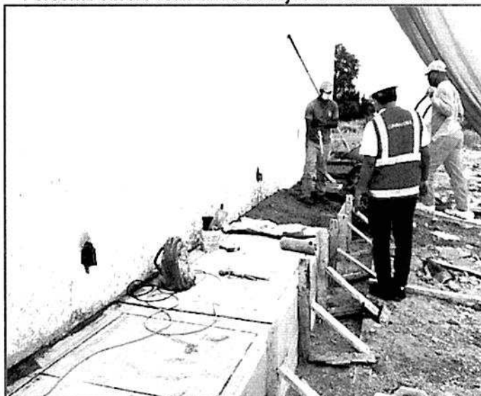
Imagen n.º 4 Personal obrero realizando trabajos sin contar con EPP
