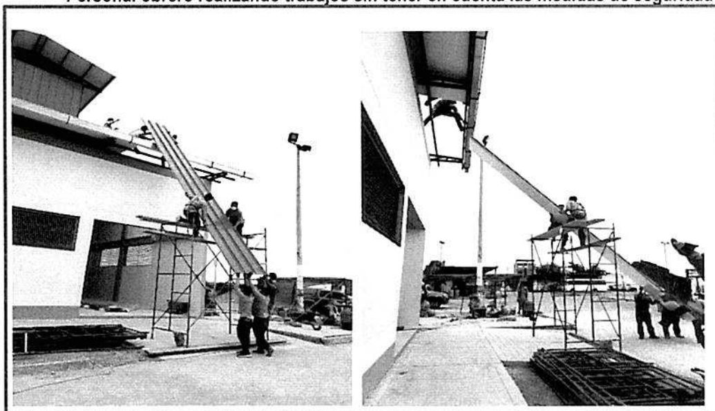
Imagen n.º 6 Personal obrero realizando trabajos sin tener en cuenta las medidas de seguridad
