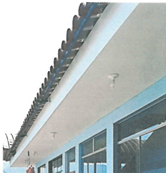
Fotografía n.º 7.- En los techos no se verifica la instalación de canaletas para el drenaje pluvial, de conformidad con lo señalado el plano Detalles de Canaleta Pluvial, lámina DP-01.
