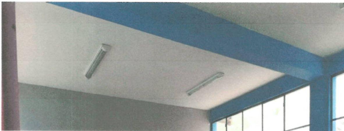
Fotografía n.º 6.- Se verifica el techo aligerado de todos los ambientes construidos, que no es a dos aguas, como indica el plano Estructuras – Aligerados y Vigas (administrativo), lámina AV-01.
