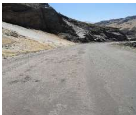
Fotografía N° 27: Progresiva km 70+350 – Desgaste leve de la superficie imprimada en carril izquierdo – presencia de huecos y peladuras en la reparación – tramo recto.
