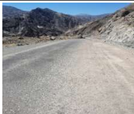
Fotografía N° 22: Progresiva km 62+000 – Desgaste leve de la superficie imprimada y en ambos carriles – evidencia de huecos en la reparación – tramo recto.
