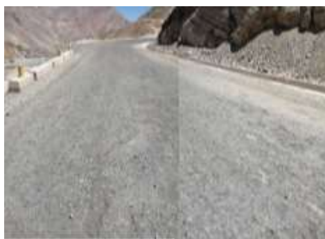
Fotografía N° 33: Progresiva km 84+900 – Desgaste moderado a severo de la superficie imprimada y en ambos carriles, desprendimiento de material granular – evidencia de huecos en la reparación – tramo recto.
