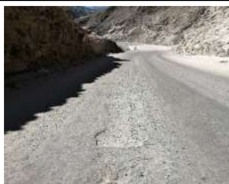
Fotografía N° 24: Progresiva km 62+200 – Presencia de baches y desprendimiento de material granular, desgaste moderado de superficie imprimada en carril izquierdo – tramo recto.
