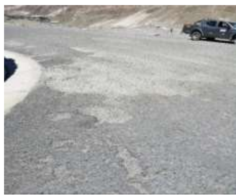
Fotografía N° 36: Progresiva km 85+200 – Presencia de baches y desgaste severo de la superficie imprimada en ambos carriles – afectación de base granular – tramo curvo.
