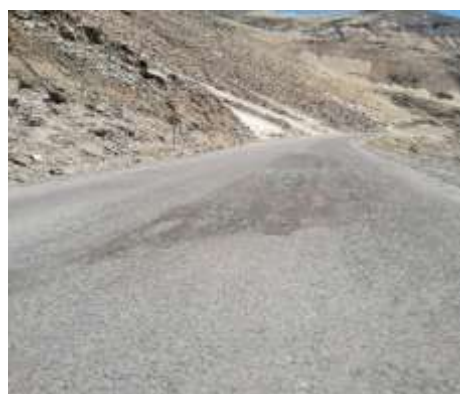
Fotografía N° 28: Progresiva km 70+580 – Desgaste moderado de superficie imprimada en carril izquierdo – presencia de peladuras en la reparación – tramo recto.
