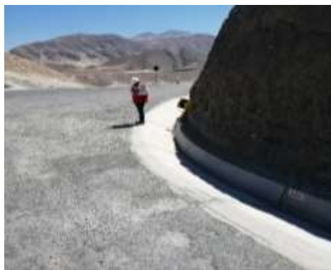
Fotografía N° 35: Progresiva km 85+160 – Presencia de baches y desgaste severo de la superficie imprimada en ambos carriles – afectación de base granular – tramo curvo.
