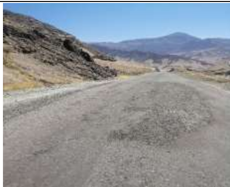
Fotografía N° 29: Progresiva km 70+720 – Desgaste moderado de superficie imprimada en carril izquierdo – presencia de peladuras en la reparación – tramo recto.
