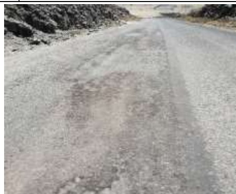
Fotografía N° 30: Progresiva km 70+920 – Desgaste moderado de superficie imprimada en carril izquierdo – presencia de peladuras en la reparación – tramo recto.
