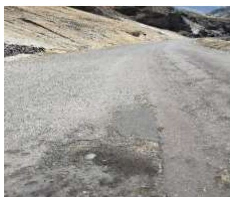
Fotografía N° 26: Progresiva km 70+240 – Desgaste leve a moderado de superficie imprimada en carril derecho – presencia de peladuras en la reparación – tramo recto.
