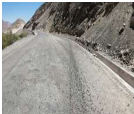
Fotografía N° 31: Progresiva km 84+550 – Presencia de rocas al pie de talud – desgaste moderado a severo de superficie imprimada en ambos carriles de la vía – afectación de base granular – tramo recto.
