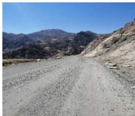
Fotografía N° 20: Progresiva km 61+700 – Desgaste severo y pérdida total de la superficie imprimada en carril derecho – afectación de base granular – tramo recto.
