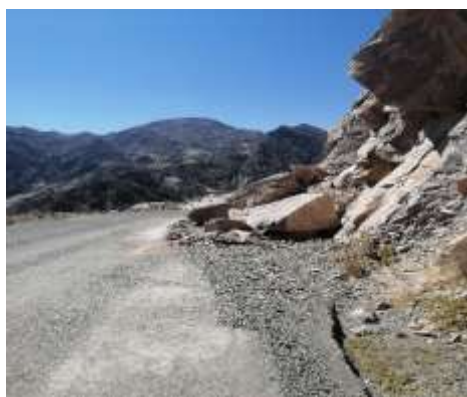
Fotografía N° 19: Progresiva km 61+660 – Presencia de rocas de grandes dimensiones sobre carril derecho – desgaste moderado de superficie imprimada en ambos carriles de la vía – tramo recto.
