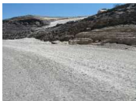
Fotografía N° 34: Progresiva km 85+100 – Desgaste leve a moderado de la superficie imprimada y en ambos carriles – desprendimiento de material granular – tramo recto.
