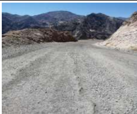
Fotografía N° 21: Progresiva km 61+800 – Presencia de baches y desprendimiento de material granular, desgaste severo en superficie imprimada en ambos carriles – afectación de base granular – tramo recto.
