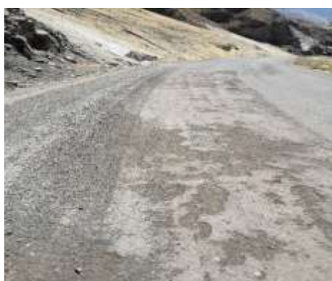
Fotografía N° 25: Progresiva km 70+200 – Desgaste moderado de superficie imprimada en carril izquierdo – presencia de peladuras en la reparación – tramo recto.
