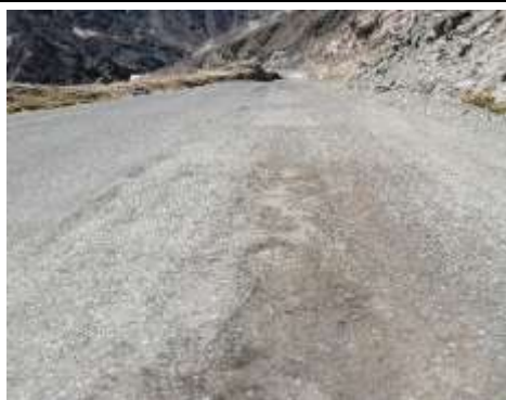
Fotografía N° 23: Progresiva km 62+120 – Desgaste leve de la superficie imprimada en carril derecho – evidencia de peladuras en la reparación – tramo recto.
