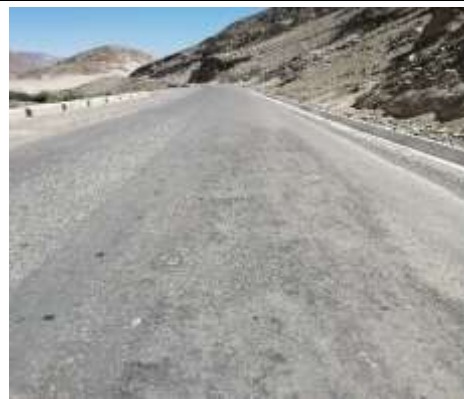
Fotografía N° 32: Progresiva km 84+580 – Desgaste leve de la superficie imprimada y en ambos carriles – evidencia de peladuras en la reparación – tramo recto.
