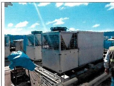
Fotografía N° 9 Cabina de enfriamiento (equipamiento) del sistema de aire acondicionado instalado
