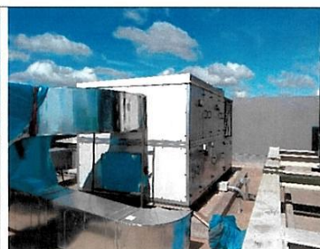
Fotografía N° 10 Vista posterior de la cabina de enfriamiento del sistema de aire acondicionado
