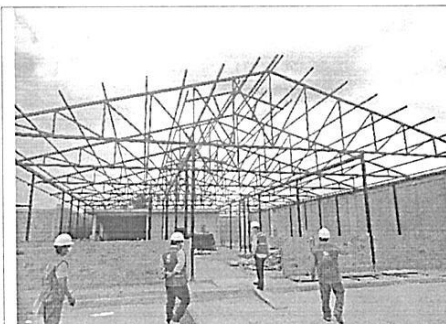
Fotografía N° 7. Estructuras metálicas de ambientes de hospitalización los que tampoco se encuentran en ejecución por falta de cobertura.
