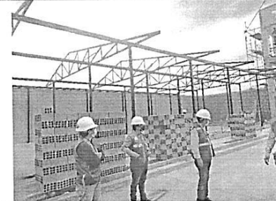
Fotografía N° 6. Estructuras metálicas de ambientes de consultorios, no están siendo ejecutadas, por falta de cobertura metálica.
