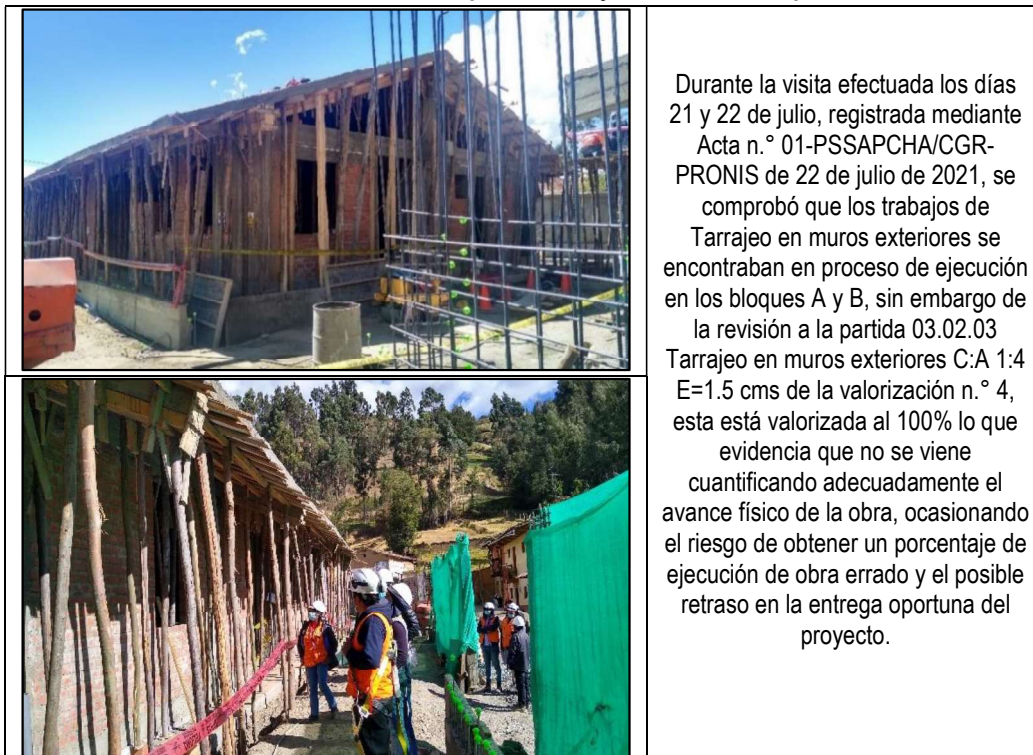
Vista Exterior del Bloque A – Tarrajeo Exterior Incompleto
