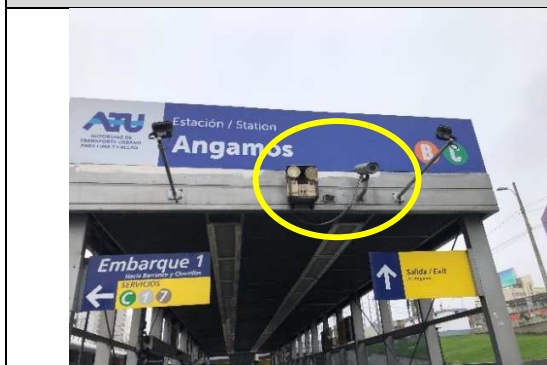
Fotografía N° 20: Vista de Luces de emergencia inoperativas en Los andenes de embarque de la estación Angamos. Se incumple el RNE, Norma Técnica EM-0.10 y Norma Técnica A-130.
