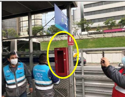
Fotografía N° 12: Vista del porta extintor señalizado, en la zona de andén del embarque de la Estación Canaval y Moreyra, en la que no existe el Extintor correspondiente.
