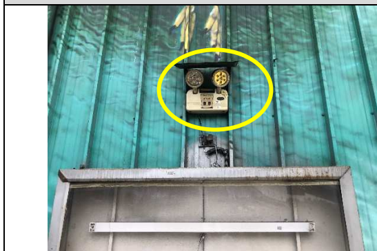
Fotografía N° 18: Vista de luces de emergencia inoperativas, dos (2) de diez(10) luces de emergencia están inoperativas en el terminal Matellini. Se incumple RNE Norma Técnica EM-0.10 y Norma Técnica A-130.
