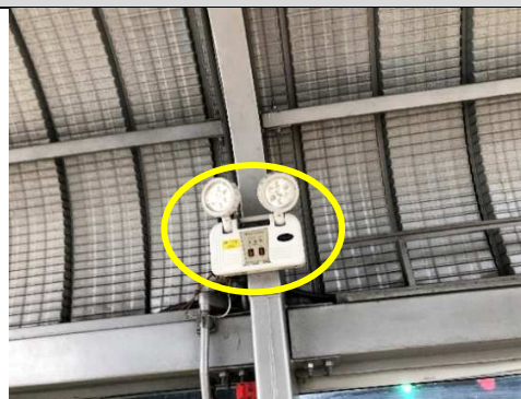
Fotografía N° 19: Vista de luces de emergencia inoperativas, dos (2) de diez(10) luces de emergencia están inoperativas en el terminal Matellini. Se incumple RNE Norma Técnica EM-0.10 y Norma Técnica A-130..
