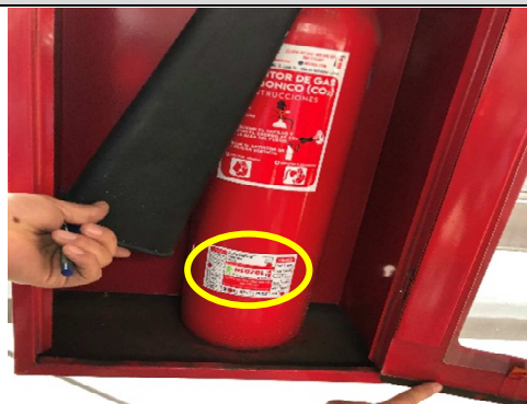
Fotografía N° 11: Vistan de un (1) extintor de CO2 vencido (diciembre-2020), en la zona de andén de embarque N° 3 de la Estación Canaval y Moreyra.
