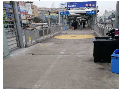
Fotografía N° 27: Vista del Andén que conduce hacia la zona de embarque lado Sur de la Estación España, en la que no se observa señalización podotáctil para uso de personas con discapacidad visual.
