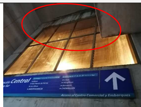
Fotografía N° 29: Se evidencia filtración de agua en el ingreso de la estación Central en la estación Central. Se incumple el RNE- Norma Técnica GE 0.40.
