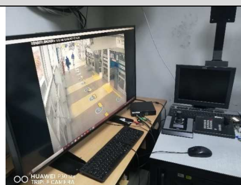
Fotografía N° 23: En la visita se advirtió la inoperatividad de ciento cuarenta y tres (143) de trescientos setenta y siete (377) cámaras de vigilancia en el sistema COSAC I.
