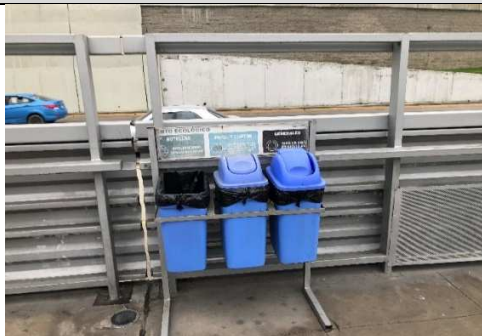
Fotografía N° 56: Vista del punto de acopio de residuos sólidos de la zona de andén – sentido norte, Estación Angamos, se observó que no se cumple con el código de colores para la segregación y almacenamiento de los residuos, conforme al DL 1278 y la NTP 900.058-2019.
