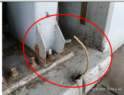
Fotografía N° 37: Falta de aterramiento de la estructura metálica del terminal Naranjal, embarques del Exp 5. Se incumple el CNE-060.
