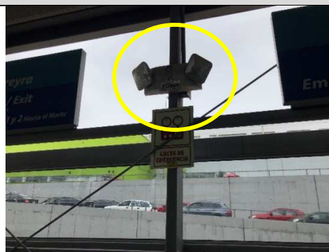
Fotografía N° 21: Vista de Luces de emergencia inoperativas en los andenes de embarque de la estación Canaval y Moreyra. Se incumple el RNE Norma Técnica EM-0.10 y Norma Técnica A-130..
