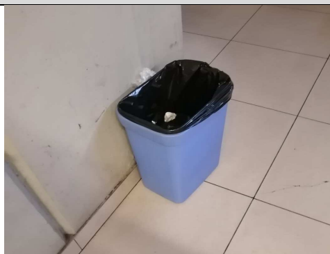
Fotografía N° 64: Vista del punto de acopio de residuos sólidos de la zona de andenes, lado Sur Este de la Estación Central, se observó un contenedor sin tapa y sin rotulo o etiqueta que señale el tipo de residuo a segregar y almacenar, conforme al DL 1278 y la NTP 900.058-2019.
