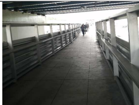
Fotografía N° 25: Vista del andén que interconecta el lado Norte y Sur de la Estación Canada, en la que se evidencia la falta de señalización podotáctil para el uso de personas con discapacidad visual.
