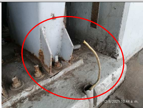
Fotografía N° 36: Falta de aterramiento de la estructura metálica del terminal Naranjal, embarques del Exp 5. Se incumple el CNE-060.
