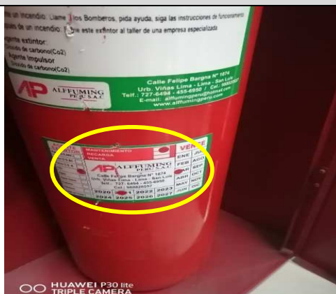
Fotografía N° 09: Vistan de un (1) extintor de CO2 vencido (marzo-2021), en la zona de andén de embarque de la Estación Angamos.
