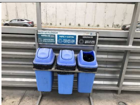
Fotografía N° 58: Vista del punto de acopio de residuos sólidos de la zona de andén, Estación Domingo Orué, se observó que no se cumple con el código de colores para la segregación y almacenamiento de los residuos, conforme al DL 1278 y la NTP 900.058-2019.
