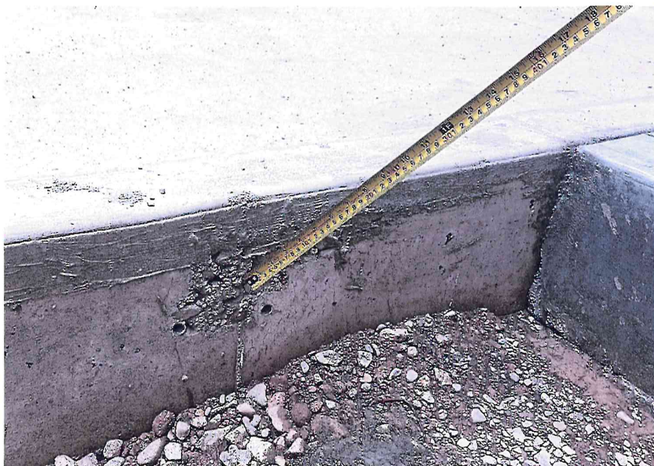
Imagen n.º 10 Segregación de concreto en concreto de veredas
