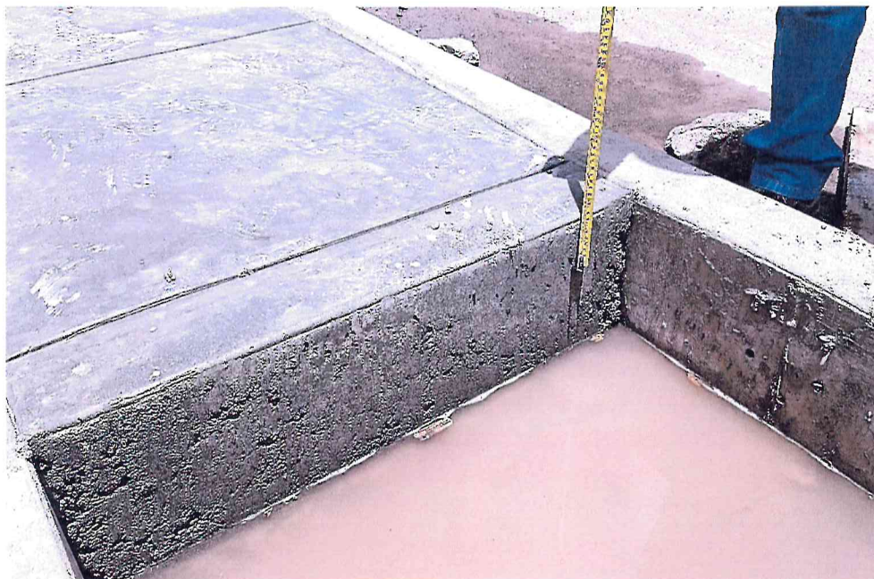
Imagen n.° 8 Segregación de concreto en veredas
