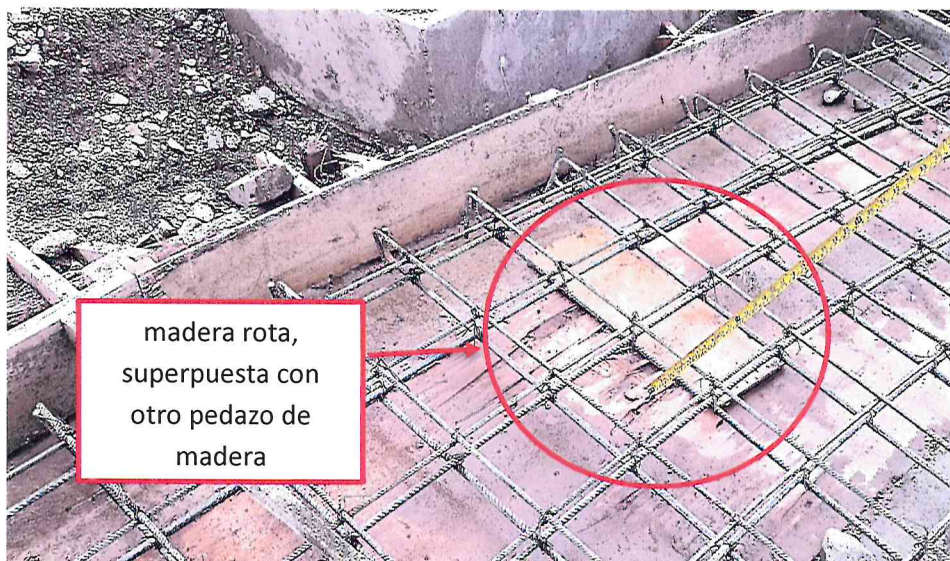
Imagen n.º 17 Encofrado de tapa de canal con materiales deteriorados
