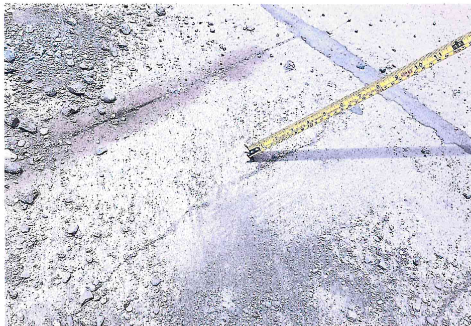
Imagen n.º 2 Fisuras en pavimento rígido de concreto f_c=210 kg/cm 2
