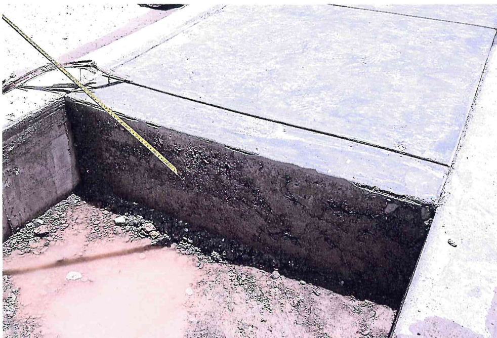
Imagen n.° 9 Segregación de concreto en veredas
