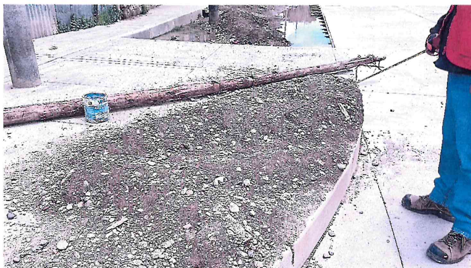
Imagen n.º 14 Restos de material excedente en la construcción de la obra
