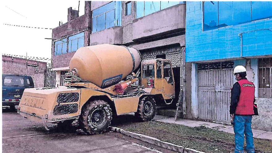
Imagen n.º 15 Falta de señalización para maniobra de maquinarias
