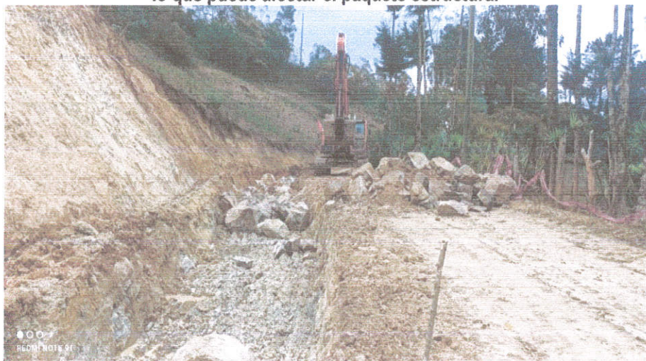
Imagen n.º 4 Excavación donde se observa las filtraciones en la vía, lo que puede afectar el paquete estructural
