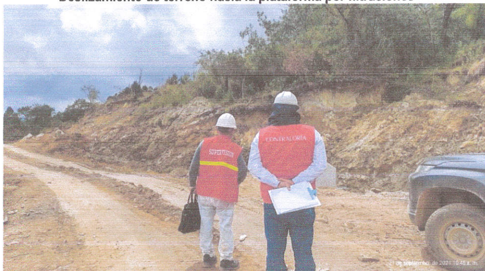
Imagen n.° 1 Deslizamiento de terreno hacia la plataforma por filtraciones
