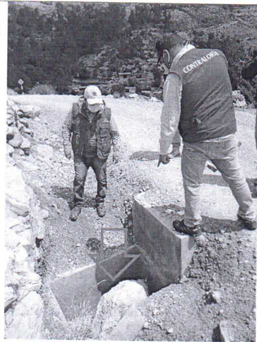
Se muestra la ausencia de limpieza de alcantarillas
