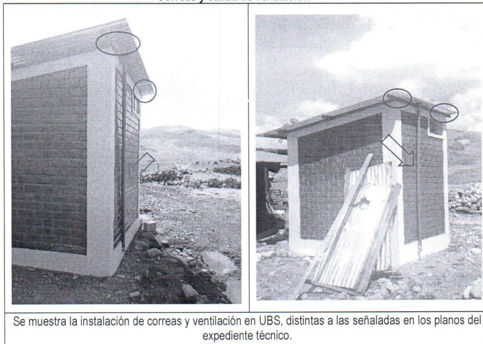
Imagen n.º 1 Correas y salida de ventilación
