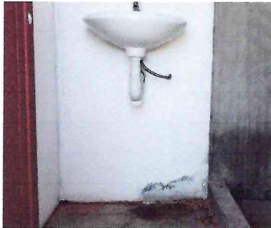
FOTOGRAFIA N° 4 UBS N° 321 – FILTRACION DE AGUA DEL CHICOTILLO
