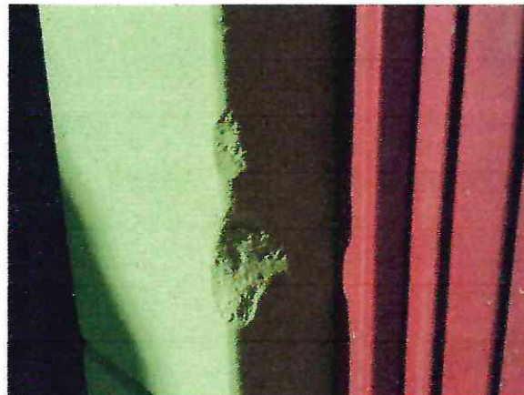
FOTOGRAFIA N° 5 UBS N° 323 – DEFECTOS EN EL MARCO DE LA PUERTA
