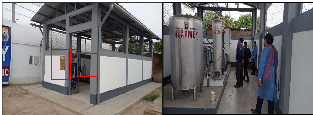
IMAGEN N° 7 PLANTA DE OXIGENO MEDICINAL SIN SEÑALIZACIÓN CORRESPONDIENTE
