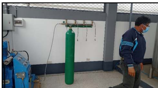
IMAGEN N° 5 LLENADO DE BALÓN DE OXÍGENO 10M³-HOSPITAL DE APOYO DE HUARMEY
