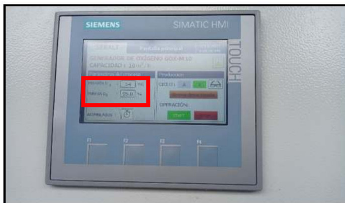
IMAGEN N° 4 PANEL DE CONTROL DE PLANTA GENERADORA DE OXIGENO- NIVEL DE PUREZA DE OXIGENO PRODUCIDO
