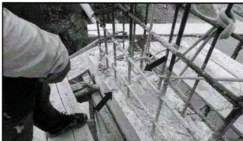
Imagen n.º 12 Tomas fotográficas a denotando fisuras en el ancho del Muro de Contención Paño n.º 8
