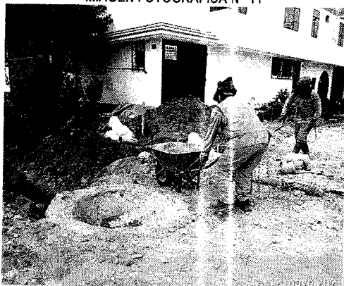
Vista de buzón destapado ubicado en intersección de la calle Perricholi con la calle 29, que no cuenta con los dispositivos de seguridad, poniendo en riesgo a trabajador.
