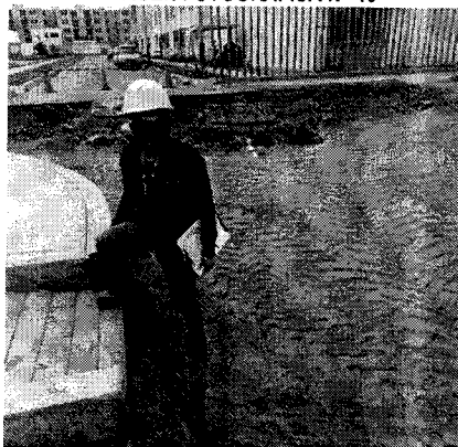
Vista de ausencia de accesos peatonales provisionales como rampas de acceso.
