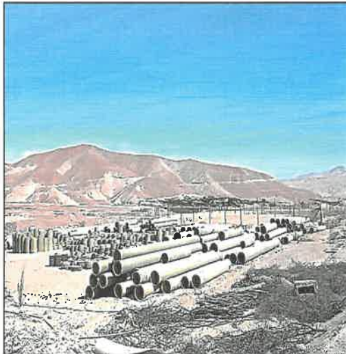
Imagen n.º 1: Saldos de tubería PRFV en el "Lote T", acopiada sin condiciones adecuadas de almacenamiento, dado que, se encuentran expuestas a los rayos ultravioletas y sin un cerco perimétrico de seguridad.
