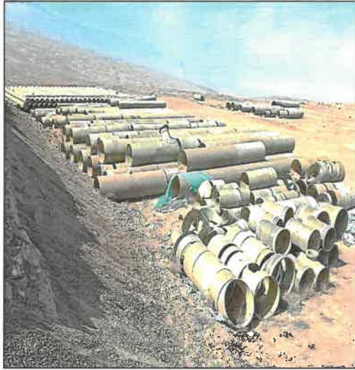
Imagen n.º 3: Saldos de tubería de GRP de 400, 600 y 800 mm de diámetro, acopiada sobre un terreno en la parte baja del reservorio n.º 01 de las lomas de Ilo.
