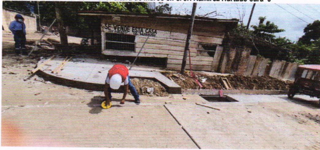
Imágenes n.ºs 35, 36, 37, 38 y 39 Cuneta con menor altura de muros en el Jr. Ramírez Hurtado cdra 6
