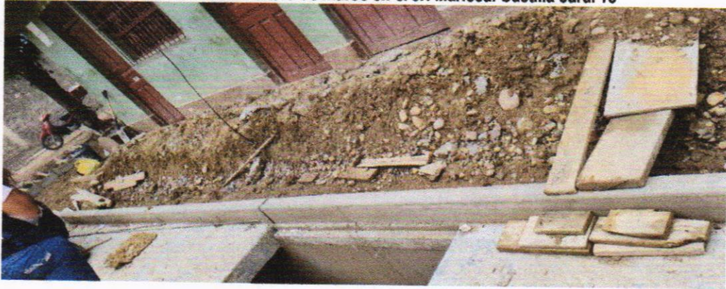
Imágenes n.ºs 30, 31, 32, 33 y 34 Cuneta con menor altura de muros en el Jr. Mariscal Castilla cdra. 15
