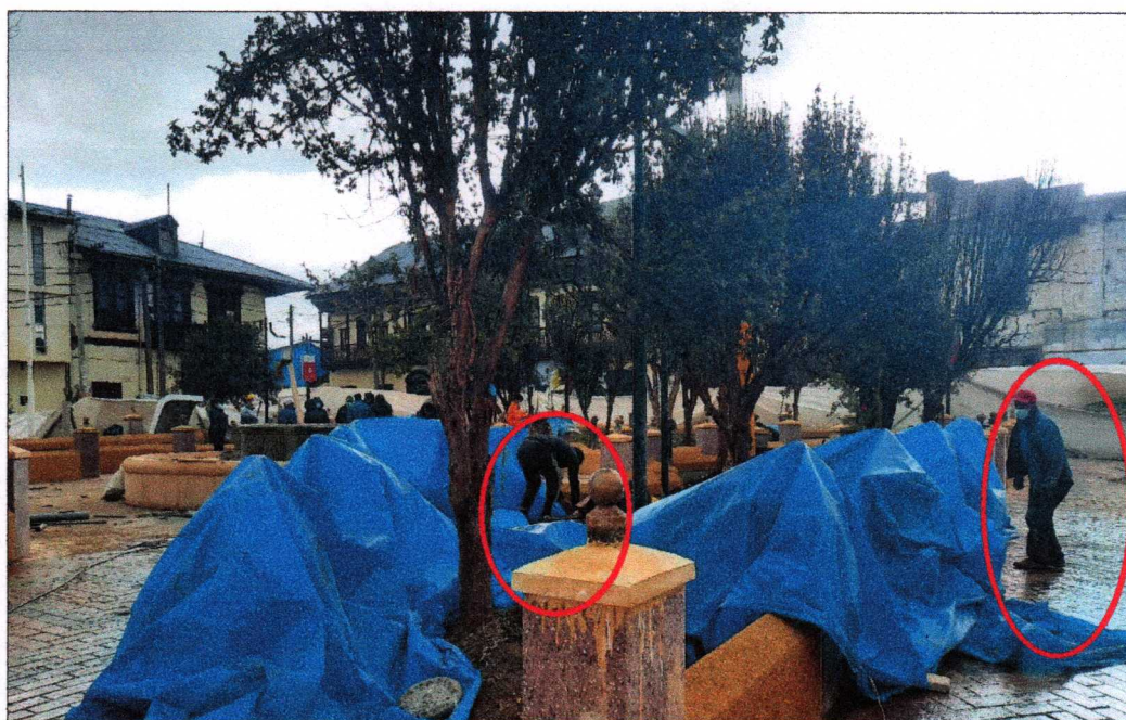
El personal que trabaja en obra no tiene EPPs de protección personal (Protector, zapato de seguridad, overol).
