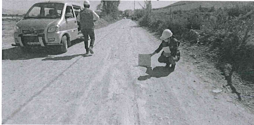
Imagen n.º 19 Vía erosionada por cursos de agua que deterioran la superficie de rodadura; ubicado en el tramo MO-607 progresiva 0+400
