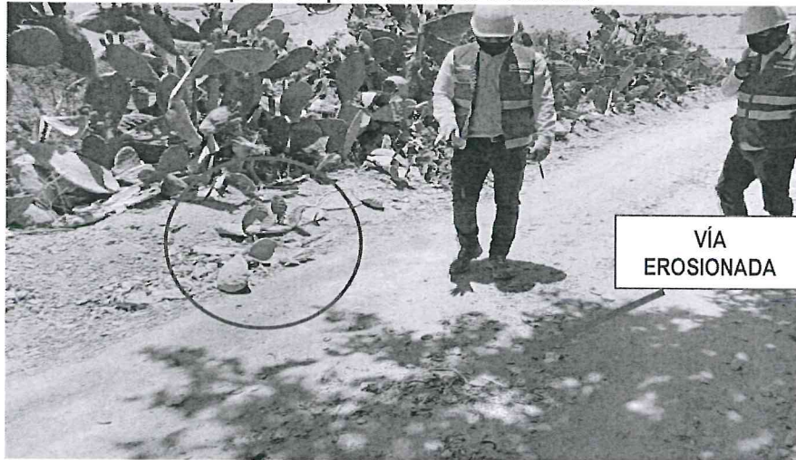
Imagen n.º 32 Falta de roce y limpieza en la vía; ubicado en el tramo R1801302. De igual modo se aprecia vía prematuramente erosionada
