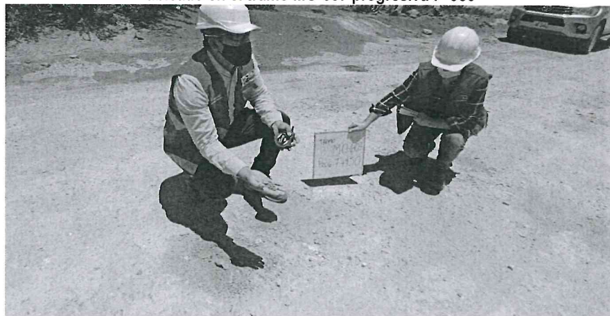
Imagen n.º 26 Ejecución de trabajos de bacheo con material fino y arcilloso en forma circular; ubicado en el tramo MO-607 progresiva 7+950
