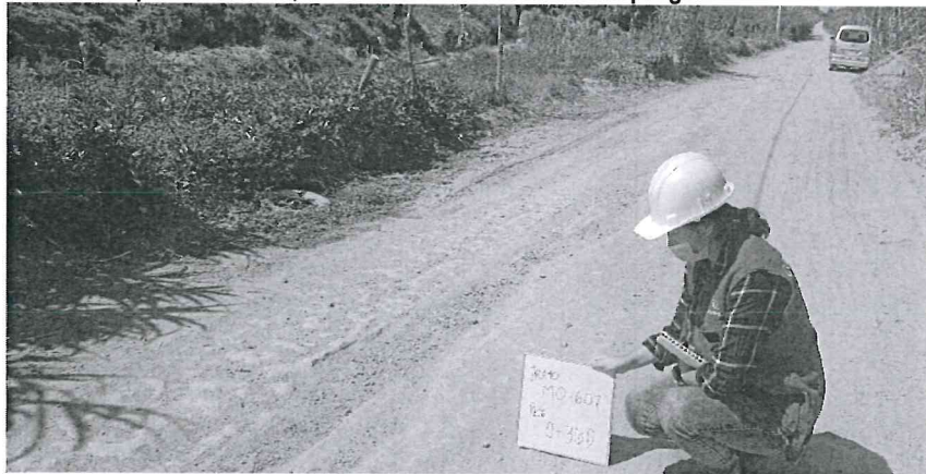
Imagen n.º 20 Vegetación en calzada y agrupamiento de material que conforman grietas pronunciadas; ubicado en el tramo MO-607 progresiva 0+360
