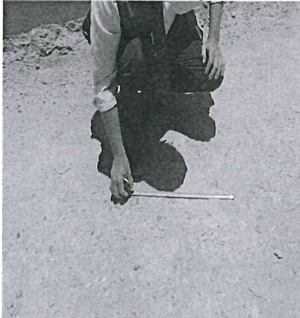
Imagen n.º 9 Material granular superior a 2" ubicado en el tramo R1801302, progresiva 5+000
