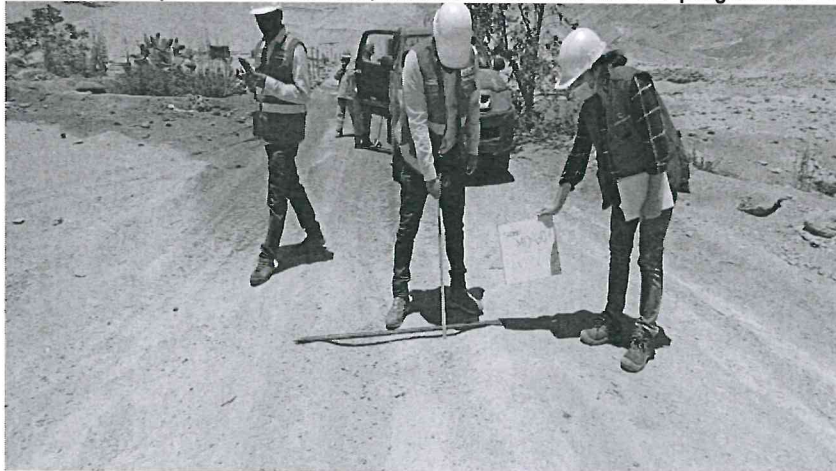
Imagen n.º 21 Bache en la superficie de rodadura; ubicado en el tramo MO-607 progresiva 8+200
