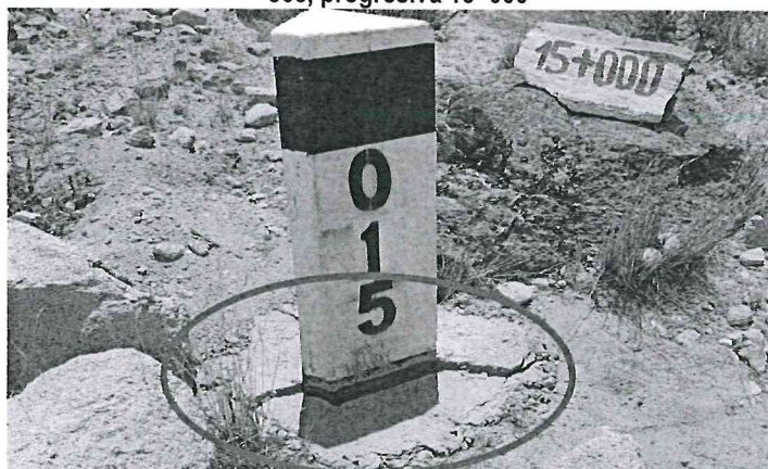
Imagen n.º 29 Grieta en la base de cemento del poste kilométrico del tramo MO- 565, progresiva 15+000
