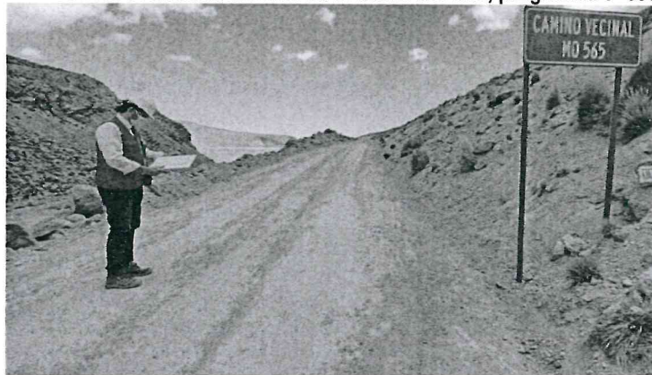
Imagen n.º 24 Cuneta colmatada ubicada en el tramo MO-565, progresiva 0+000
