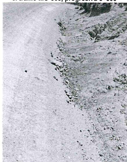
Imagen n.º 32 Obstáculos en vía (material disgregado por deslizamiento de talud), ubicado en el tramo MO-565, progresiva 8+500
