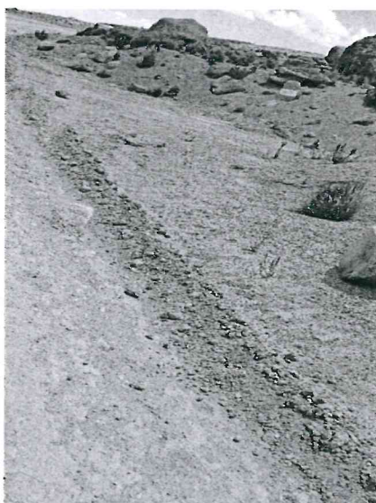
Imagen n.º 31 Cuneta colmatada, ubicada en el tramo MO-565, progresiva 3+000
