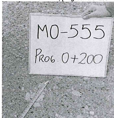
Imagen n.º 20 Material granular superior a 2" ubicado en el tramo MO-555, progresiva 0+200
