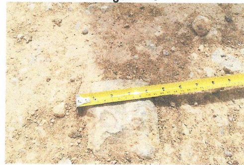
Traslape de la ruta vecinal JU-817 con vía departamental JU-113, muestra rocas mayores a dos (2) pulgadas.
