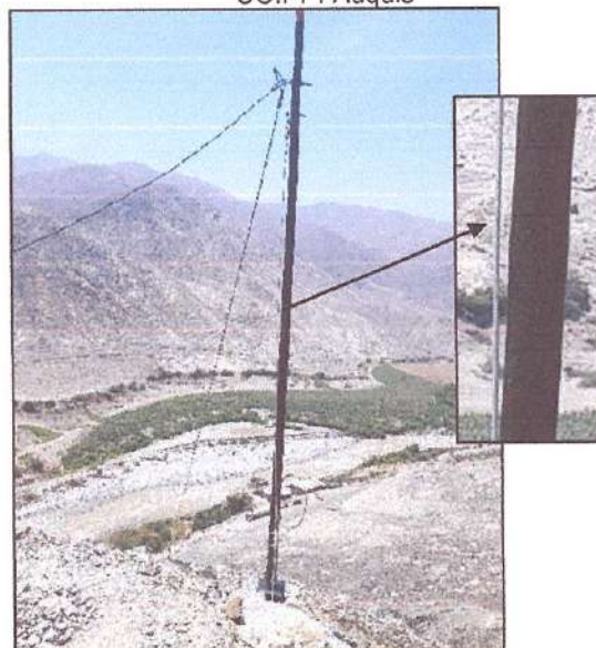
Imagen n.º 2 Retenidas sin aislador en la estación repetidora celular – antena. CC. PP. Letrayoc. CC.PP. Auquis
