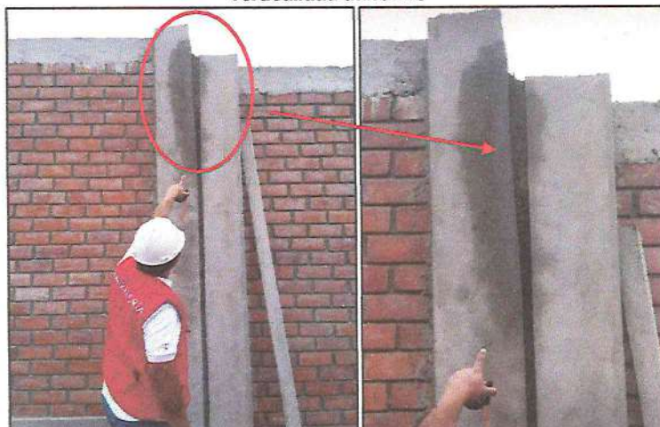
Imagen n.º 3 Tarrajeo en columnas del cerco perimétrico parte interna, sin su verticalidad uniforme
