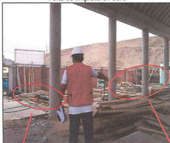
Imagen n.° 1 Falta de limpieza en obra
