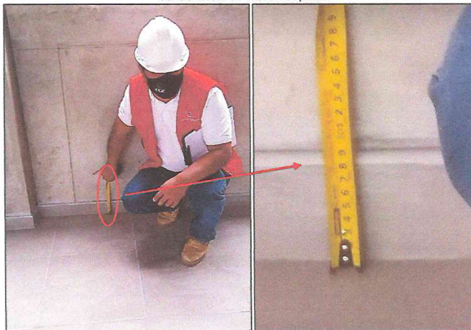
Imagen n.° 4 Contrazócalo de altura de 0,80cm
