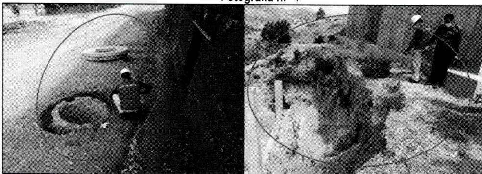
Fotografías donde se muestra que la obra no cuenta con dispositivos de seguridad y señalización
