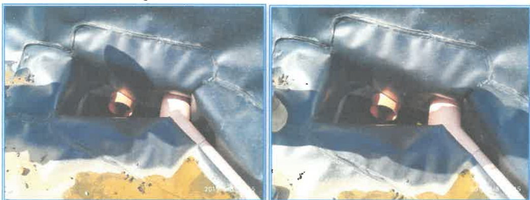
Fotografía n.º 8 Tubería de desfogue en la Celda n.º 2 de confinamiento de Residuos sólidos
