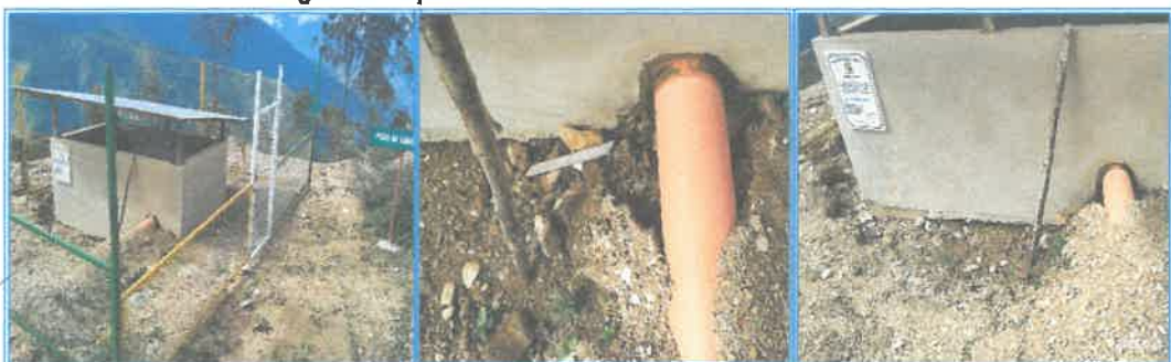
Fotografía n.º 9 Tubería de ingreso a la poza de lixiviados de la Celda n.º 2 con deficiencias
