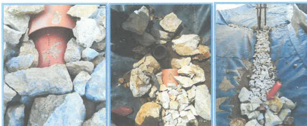
Fotografía n.º 7 Deficiencias en la instalación de la tubería de drenes
