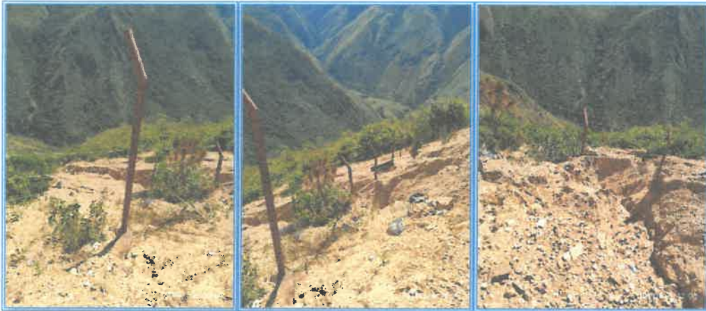
Fotografía n.º 10 Deficiencias en los cercos perimétrico
