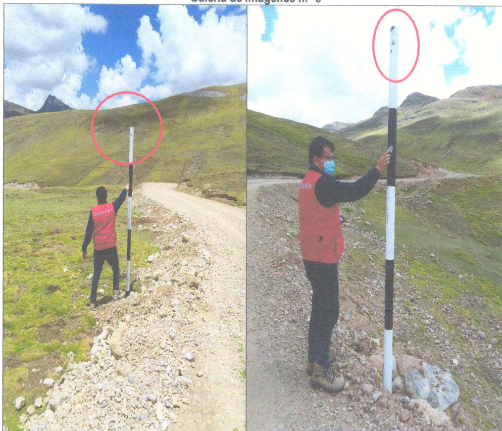
Imágenes n.ºs 9 y 10: Falta del panel de señal de tránsito, encontrándose solo el parante metálico y el dado de concreto (Progresivas 5+760 y 6+760, respectivamente.).
