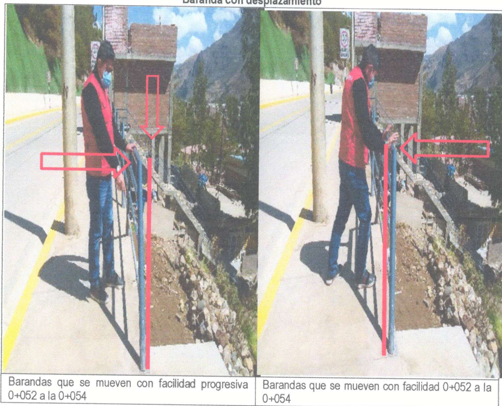
Galería de imagen n° 14 Baranda con desplazamiento
