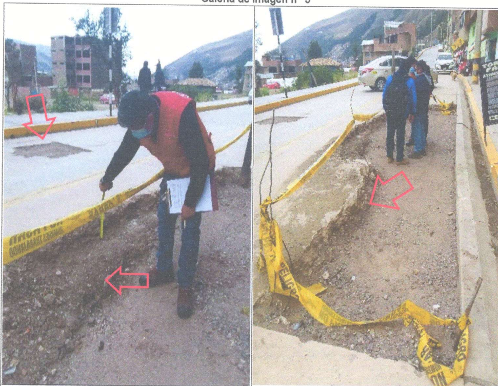
Pavimentos roturados por falla en la red matriz progresiva 0+196
