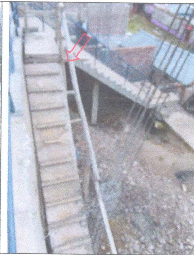
Imagen n.º 16: escalera de madera provisoriosa sin desmontar
