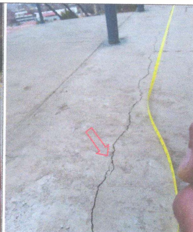
Imagen n.º 18: Fisuras en veredas
