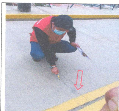
Imagen n.º 13: fisura en losa de concreto
