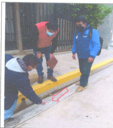
Imagen n.º 9: fisuras en cunetas
