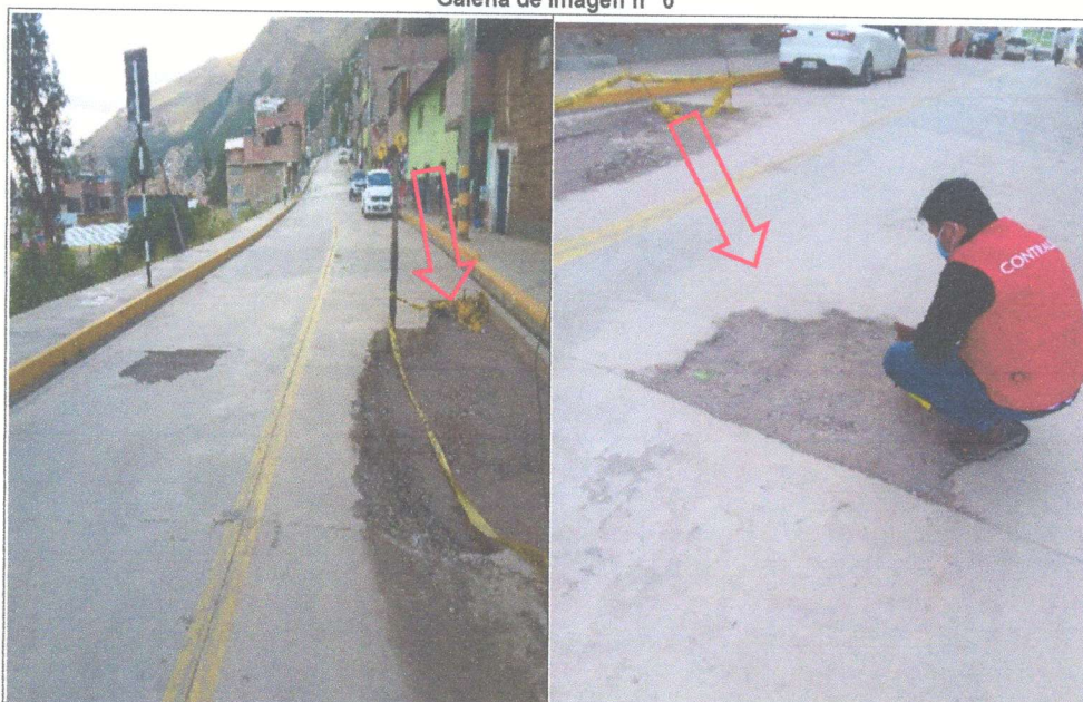
Pavimento roturados progresiva 0+196 con base expuesta en deterioro lado izquierdo
