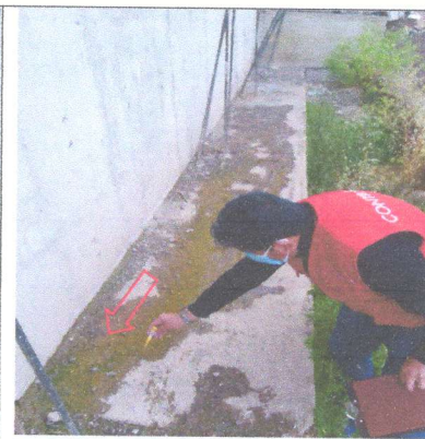
Imagen n.º 20: filtración de agua debajo del muro de contención
