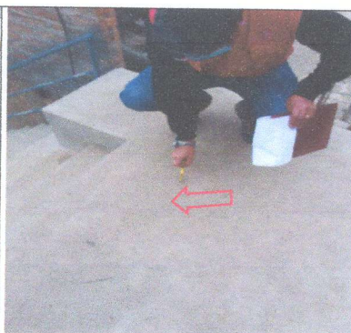
Imagen n.º 14. fisura en descanso de escalera
