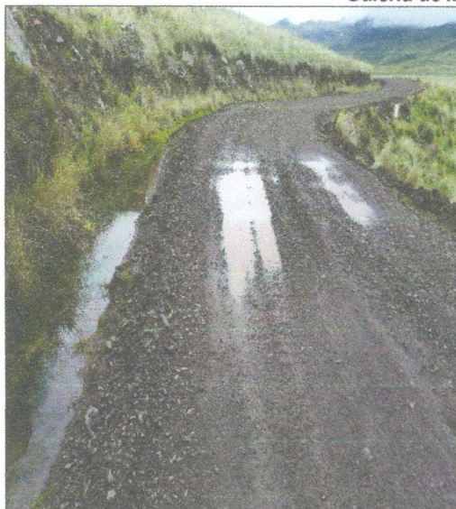
Imagen n.º 1: La capa de afirmado en la progresiva 0+200 presenta huecos, aproximadamente en una distancia de ocho (8) metros.
