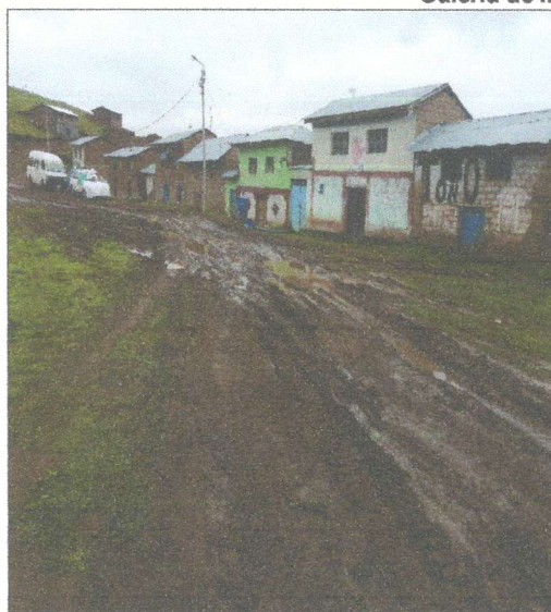
Imagen n.º 3: La capa de afirmado en la progresiva 11+000 presenta huecos y ahuellamientos, aproximadamente en una distancia de quince (15) metros.
