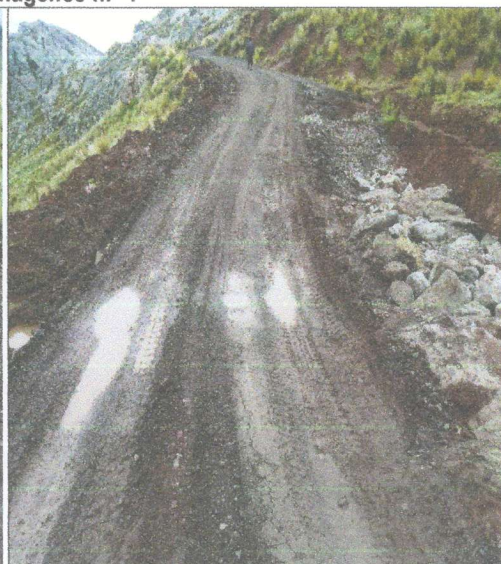
Imagen n.º 2: La capa de afirmado en la progresiva 10+000 presenta huecos, aproximadamente en una distancia de ocho (10) metros.
