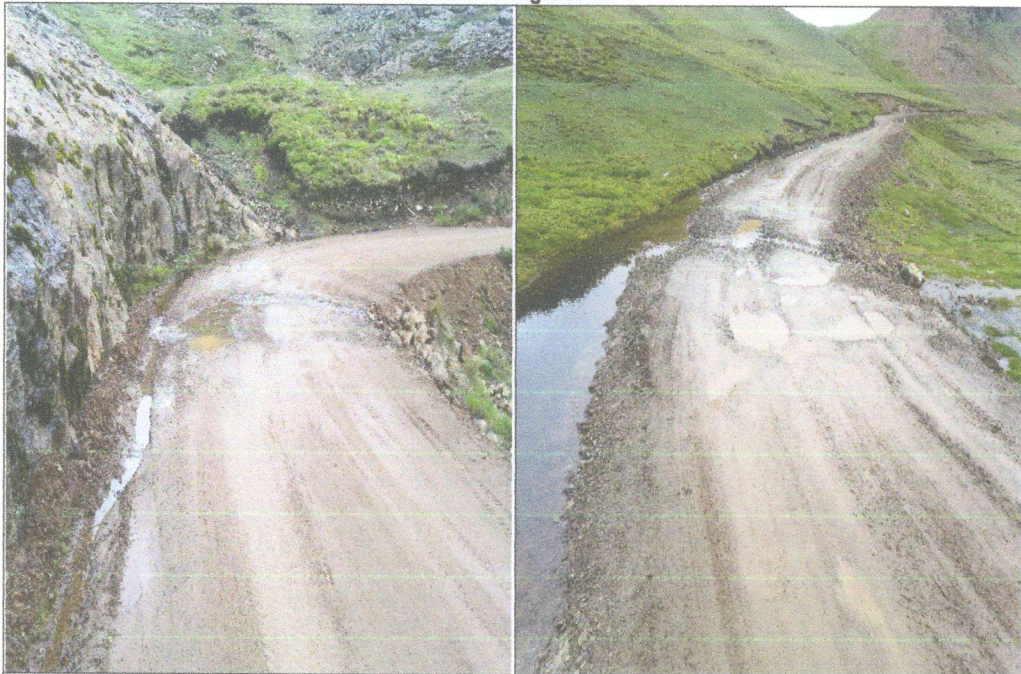
Imagen n.º 1: La cuneta de tierra en la progresiva 2+360 presenta empozamiento, lo cual humedece el lado derecho de la capa de afirmado de la carretera, aproximadamente en una distancia de siete (7) metros
