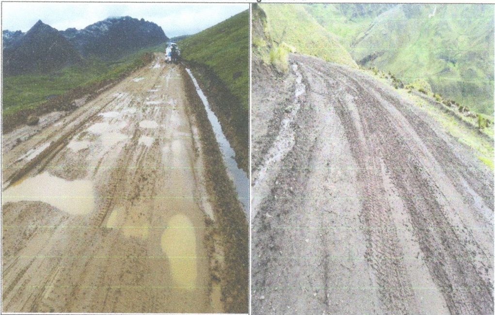
Imagen n.º 3: La capa de afirmado en la progresiva 7+400 presenta huecos y ahuellamientos aproximadamente en una distancia de doce (12) metros.
