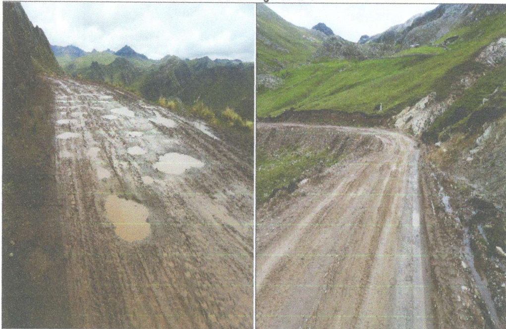
Imagen n.º 5: La capa de afirmado en la progresiva 17+500 presenta huecos y ahuellamientos aproximadamente en una distancia de trece (13) metros.
