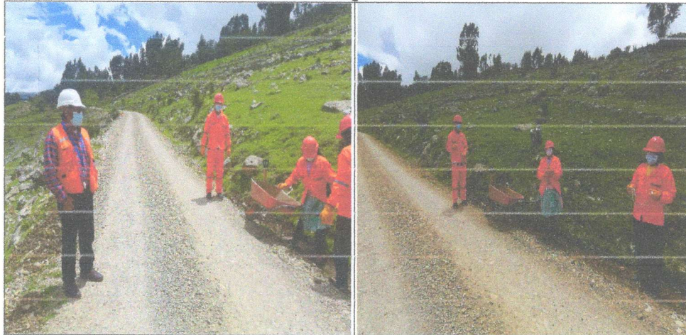
Imágenes n.º 7 y 8: Se muestra personal realizando trabajos limpieza de cunetas, sin la dirección técnica del residente ni el inspector de servicio de mantenimiento periódico, solo se halló al asistente del residente.
