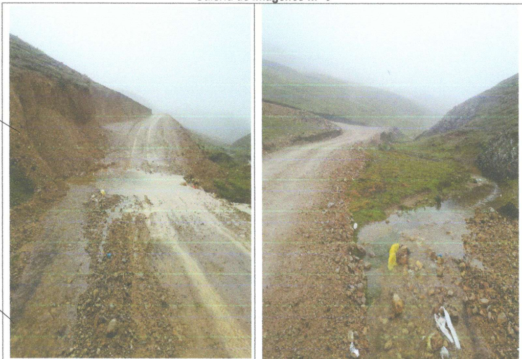
Imágenes n.ºs 5 y 6: La cuneta de tierra en la progresiva en la progresiva 11+000, presenta empozamiento la cual satura toda la capa de afirmado de la 5carretera, aproximadamente en una distancia de doce (12) metros.
