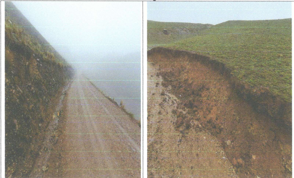
Imagen n.º 3: La cuneta de tierra en la progresiva 2+000, presenta empozamiento la cual humedece el lado derecho de la capa de afirmado de la carretera, aproximadamente en una distancia de veinte (20) metros.
