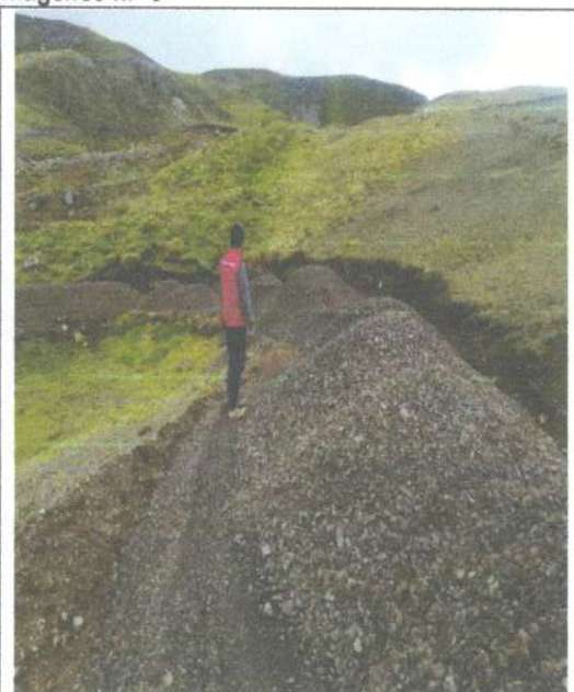
Imagen n.º 6: Desde la progresiva 7 +100 al 7+760, se encontró material granular apilado, que no sido perfilado ni compactado para la capa de afirmado.
