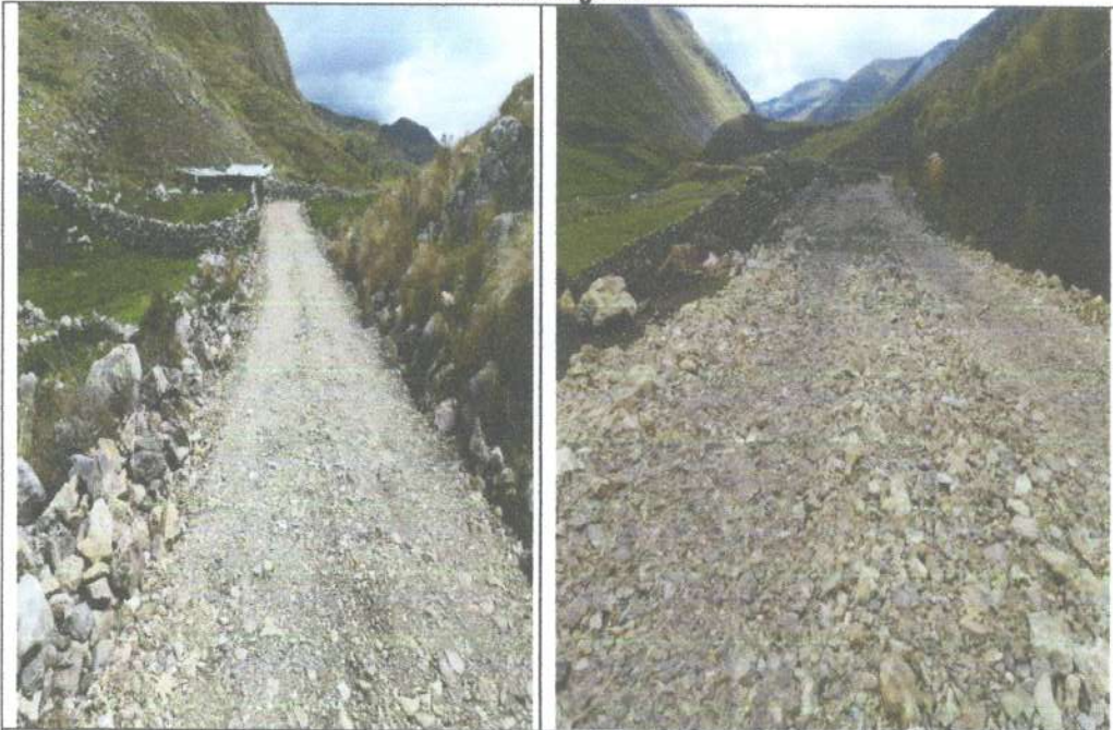
Imágenes n.ºs 1 y 2: Desde la progresiva 0+000 a la 18+560, se ha perfilado el material granular proveniente de cantera, pero éste no ha sido compactado, presentando ahuellamientos e irregularidades en la capa de afirmado de la carretera.
