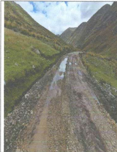
Imagen n.º 5: La cuneta de tierra en la progresiva 7+780, presenta empozamiento en la cuneta de tierra la cual humedece el lado izquierdo de la capa de afirmado de la carretera, aproximadamente en una distancia de quince (15) metros.
