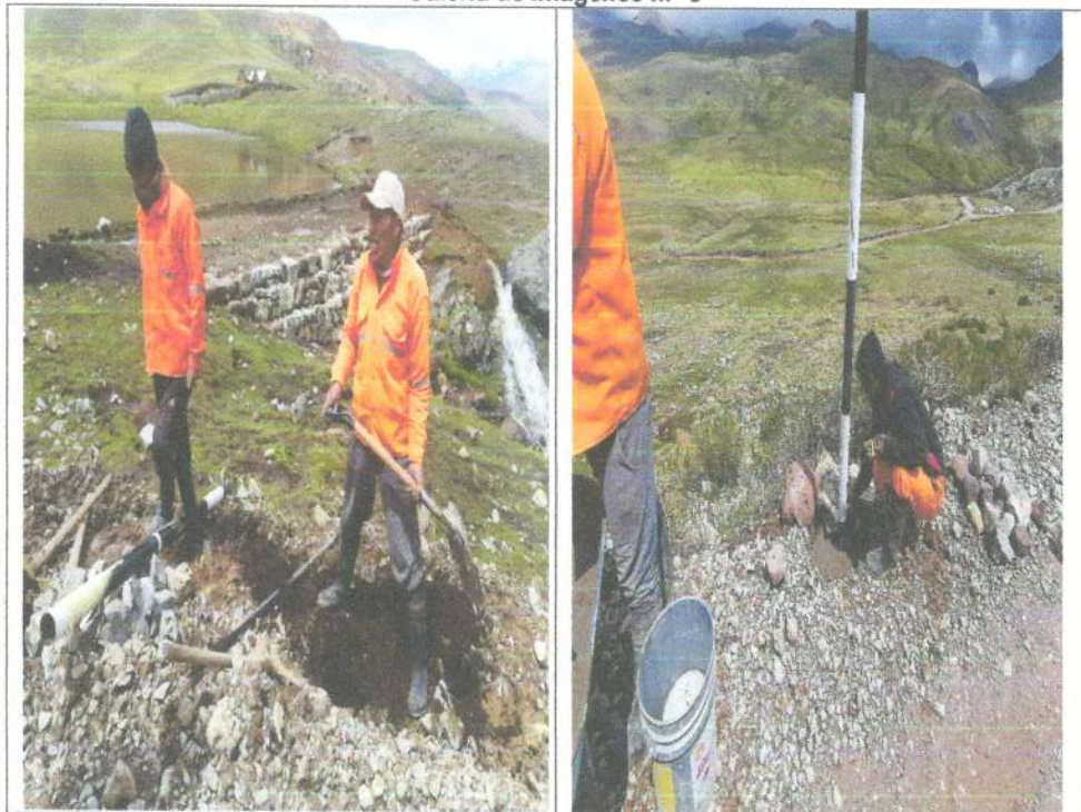
Imágenes n.º 9 y 10: Se muestra personal realizando trabajos de colocación de postes de hierro para señalización vial, sin ningún insumo de protección contra el COVID (trabajadores sin mascarilla) no conservado la distancia mínima interpersonal.
