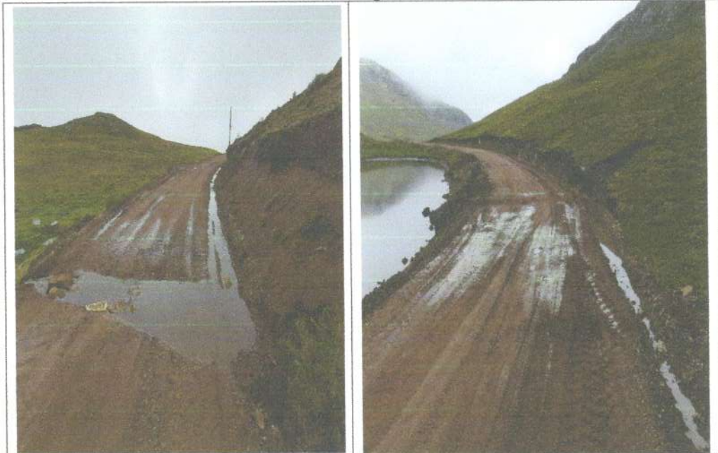
Imagen n.º 7: La cuneta de tierra en la progresiva en la progresiva 1+380, presenta empozamiento en la cuneta de tierra la cual humedece el lado derecho de la capa de afirmado de la carretera, aproximadamente en una distancia de quince (15) metros.
