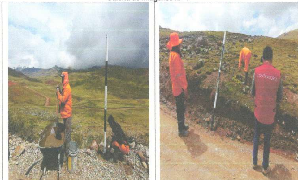
Imágenes n.º 1 y 2: Se muestra personal realizando trabajos de colocación de postes de hierro para señalización vial, sin la dirección técnica del residente ni el inspector de servicio de mantenimiento periódico.
