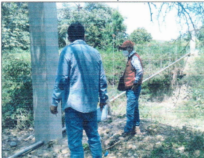
Imagen n.° 6 Pase Aéreo n.° 4 con tubería de F°G° ø 2" y tubería interna de PVC ø 1 1/2"
