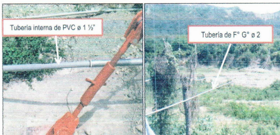
Imagen n.° 4 Pase Aéreo n.° 3 con tubería de F°G° ø 2" y tubería interna de PVC ø 1 1/2"
