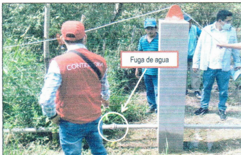
Imagen n.° 3 Pase Aéreo n.° 2 con tubería de F°G° ø 2"
