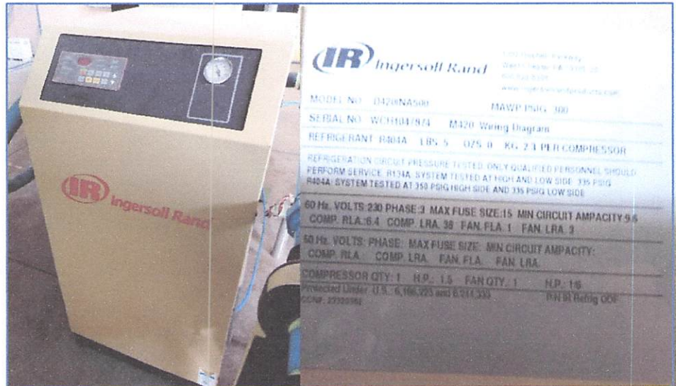
IMAGEN N° 4 SECADOR DE AIRE REFRIGERATIVO INSTALADO – MARCA: INGERSOLL RAND
