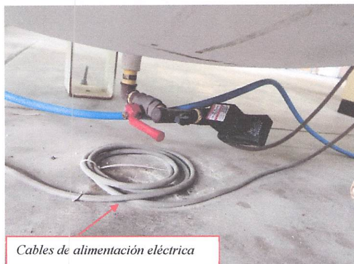
IMAGEN N° 10 VÁLVULA DE DRENAJE AUTOMÁTICO DEL TANQUE DE AIRE COMPRIMIDO
