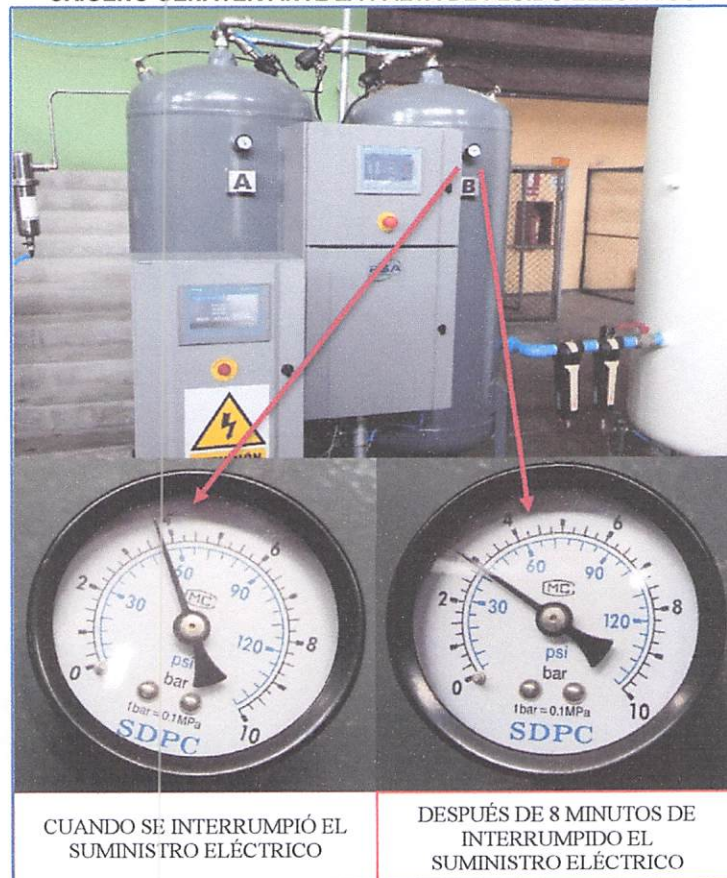
IMAGEN N° 11 VARIACIÓN DE LA PRESIÓN DEL TANQUE B DEL GENERADOR DE OXIGENO GENATEK ANTE LA FALTA DE FLUIDO ELECTRICO
