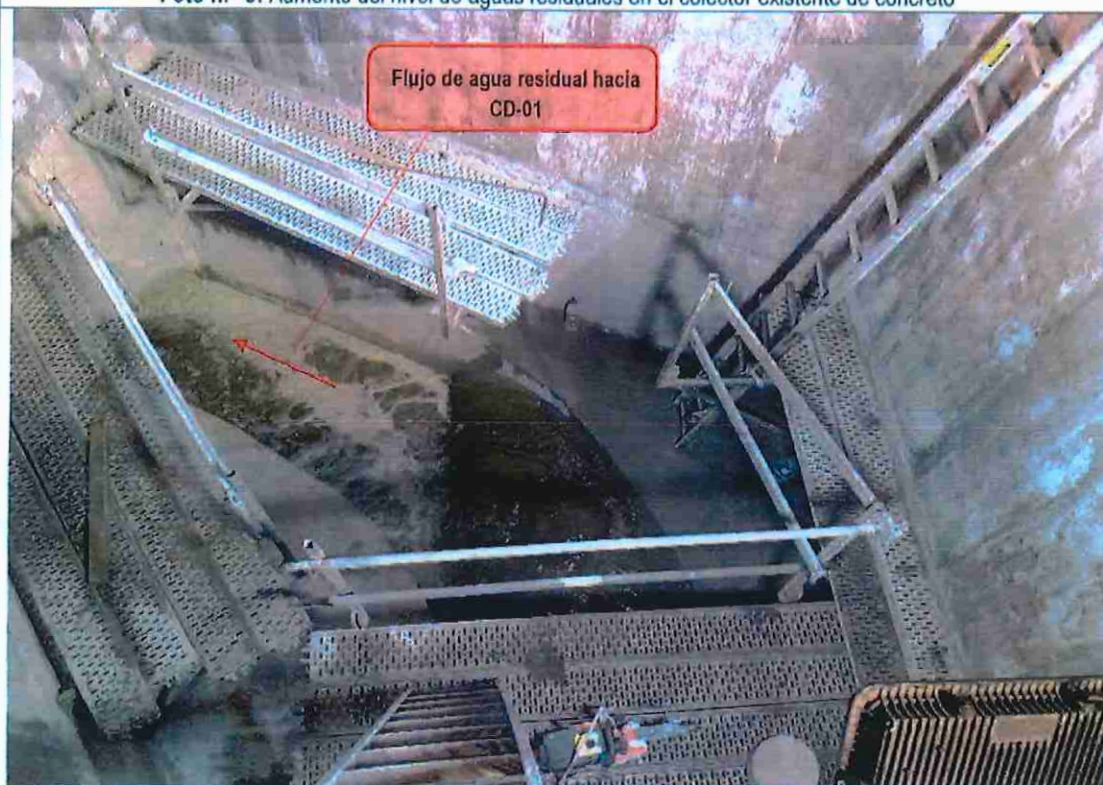
Foto n.º 5: Aumento del nivel de aguas residuales en el colector existente de concreto
