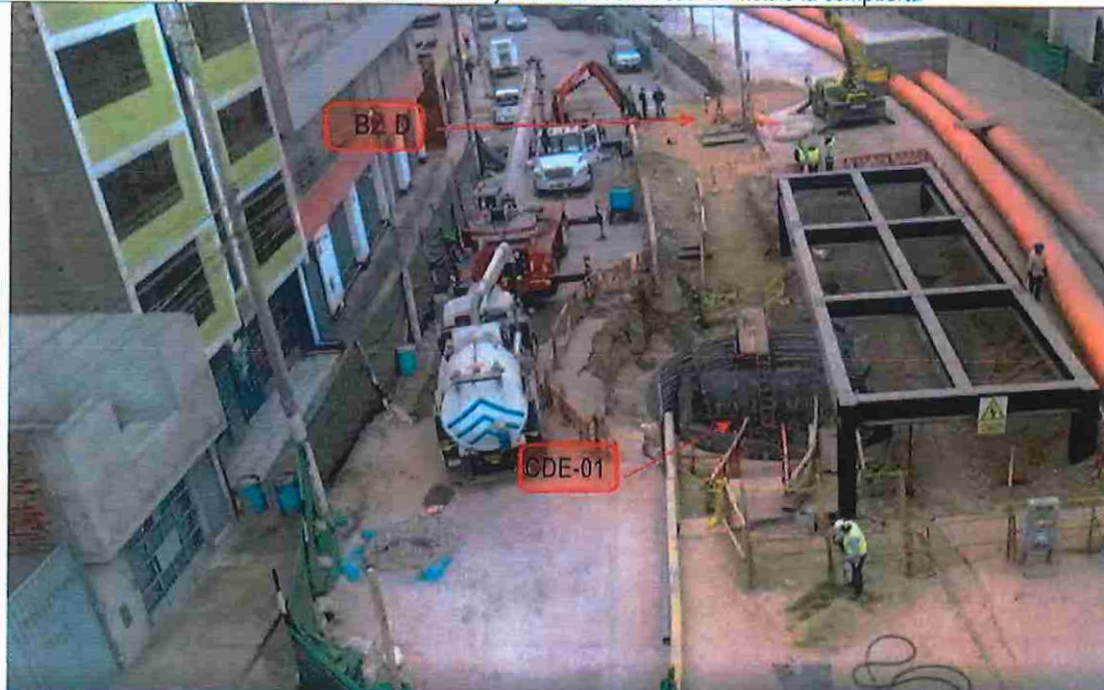
Foto n.º 1: Vista panorámica de la cámara CDE-01 y el buzón D en el cual se instaló la compuerta
