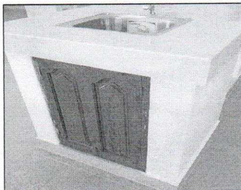
FOTOGRAFÍA N° 10 LAS PUERTAS BAJAS DE LOS LABORATORIOS NO SE COLOCARON EN SU TOTALIDAD Y NO TIENEN JALADORES.
