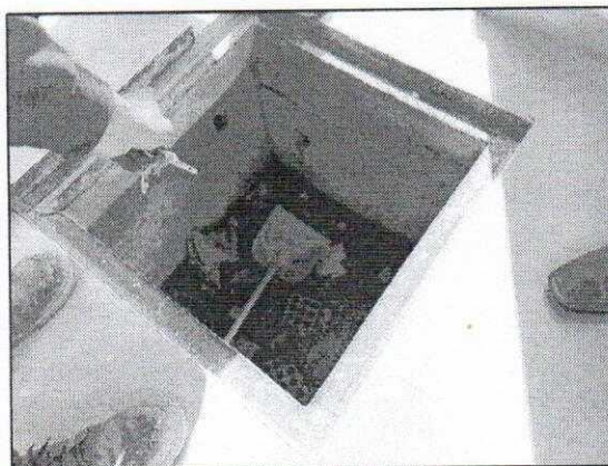
FOTOGRAFÍA N° 14 BUZÓN PARA VOZ Y DATA SIN LIMPIEZA DONDE NO SE HA CABLEADO EL SISTEMA DE DATA Y DE VOZ
