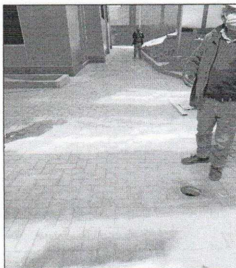
FOTOGRAFÍA N° 30 EN EL FRONTIS DEL INGRESO PRINCIPAL NO EXISTE UN SISTEMA DE DRENAJE PARA LAS AGUAS PLUVIALES, SOLO SE APRECIAN CAJAS DE REGISTRO DEL SISTEMA DE DESAGÜE
