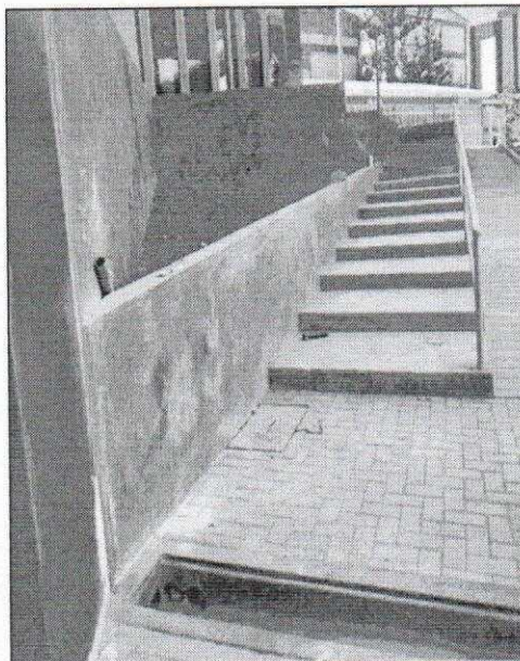
FOTOGRAFÍA N° 26 ÁREA VERDE UBICADA EN EL LADO OESTE, SE SOSTIENE EN UN MURO DE CONTENCIÓN QUE NO CUENTA CON UN SISTEMA DE DRENAJE PARA EL REGADO Y AGUAS PLUVIALES
