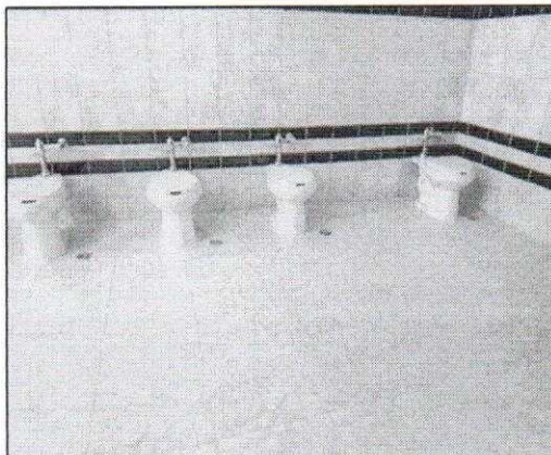
FOTOGRAFÍA N° 15 FALTA LA COLOCACIÓN DE TABIQUES SEPARADORES EN TODOS LOS SERVICIOS HIGIÉNICOS
