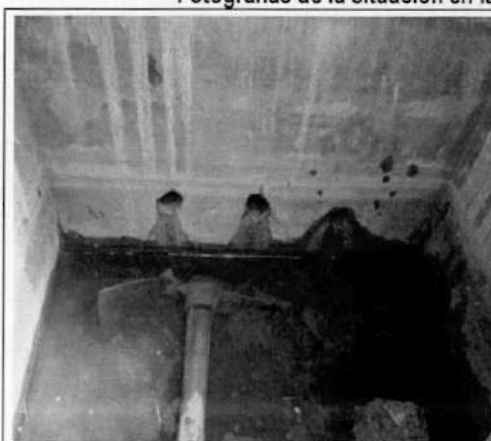
Panel fotográfico n.º 2 - Detalle de cámara húmeda Coordenadas (E:554386 N: 8576136) Obs.: El caudal captado en la cámara húmeda es de 0.01 lt/seg.
