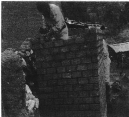
Imagen n.º 7 Caseta para UBS sin columnas de concreto de concreto armado
