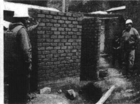
Imagen n.° 2 Caseta para UBS sin columnas de Concreto armado
