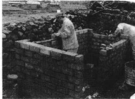
Imagen n.° 1 Caseta para UBS sin columnas de Concreto armado
