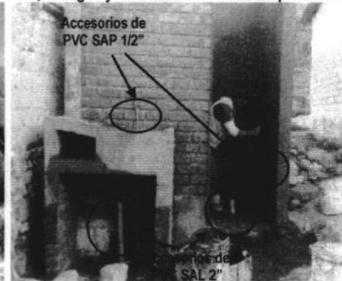
Imagen n.º 11 Tarrajeo exterior e interior con ocre color rojo, e instalación de tuberías y accesorios de agua fría, desagüe y ventilación en la caseta para UBS
