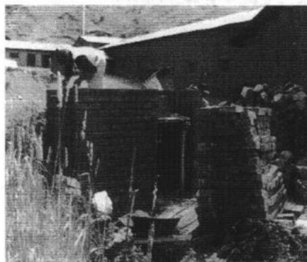
Imagen n.° 3 Caseta para UBS sin columnas de Concreto armado
