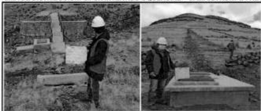
IMAGENES N°s 8 y 9 SISTEMA DE DISTRIBUCIÓN: SIFON INVERTIDO OQUEHUIRE - CAMARA ROMPE PRESIÓN
