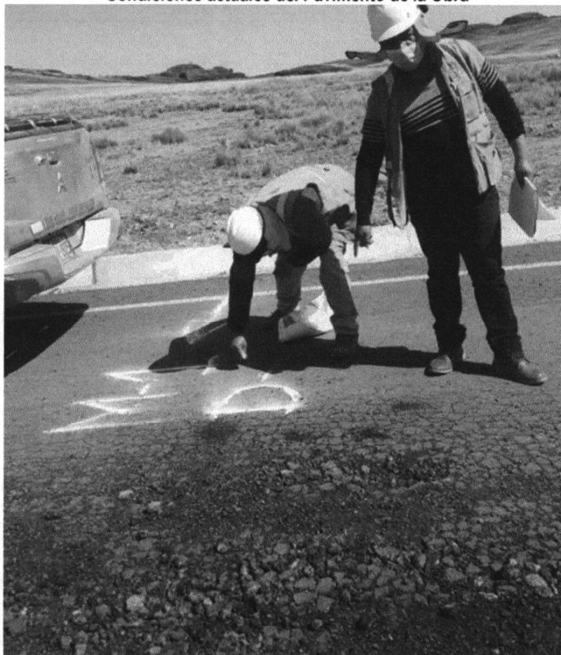
Imagen n.º 7 Condiciones actuales del Pavimento de la Obra
