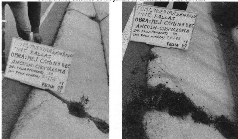
Imagen n.º 10 Condiciones actuales de las juntas de dilatación de las cunetas
