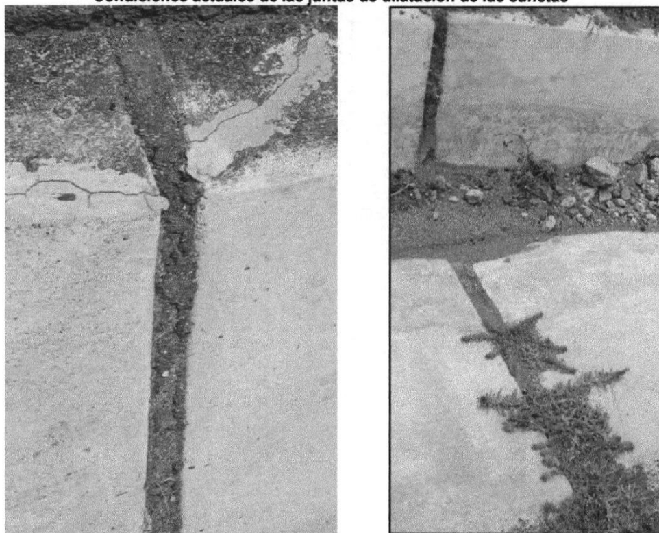
Imagen n.º 11 Condiciones actuales de las juntas de dilatación de las cunetas
