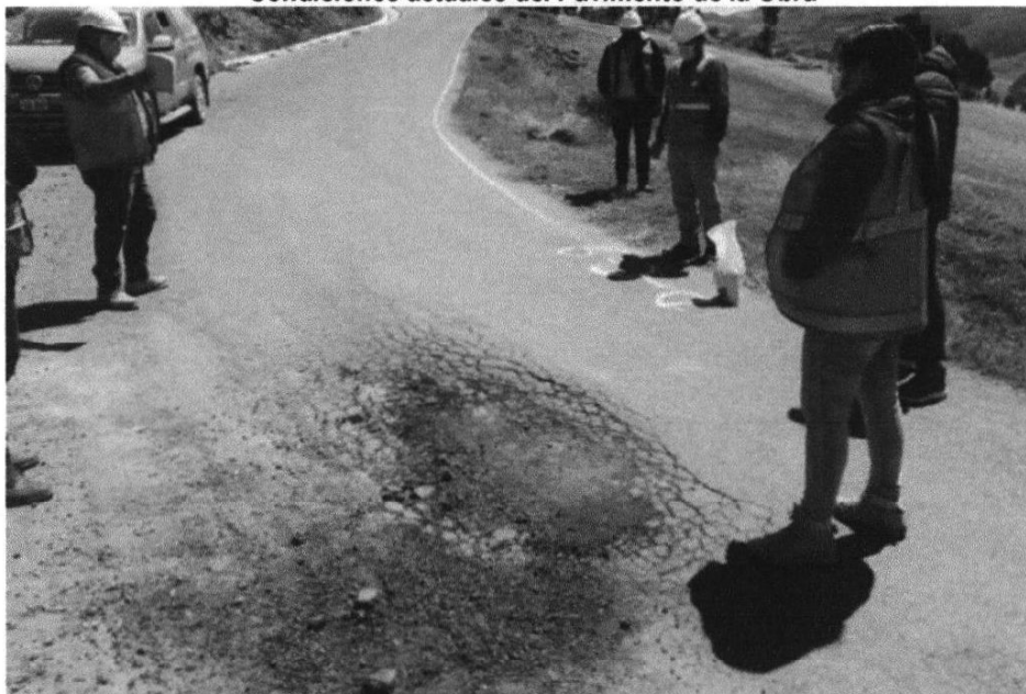
Imagen n.° 8 Condiciones actuales del Pavimento de la Obra
