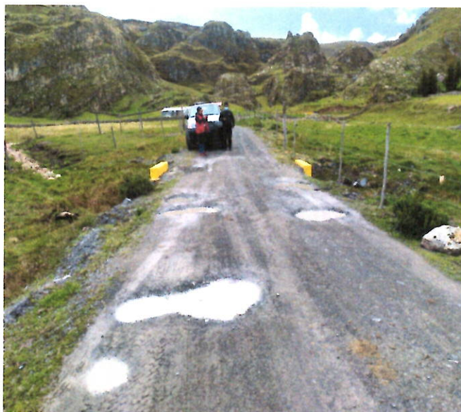
Imagen n.º 8 Ahuellamiento y pérdida de finos en la vía
