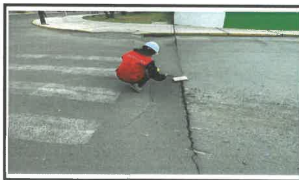
IMAGEN N° 2 HUNDIMIENTO DE PAVIMENTO
