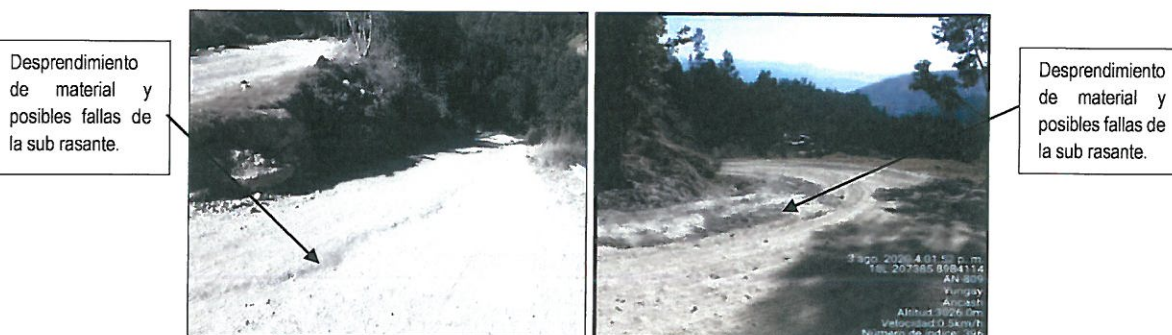
FOTOGRAFÍA N° 1 PLATAFORMA DEL CAMINO VECINAL CON SEGREGACIÓN DE PARTÍCULAS
