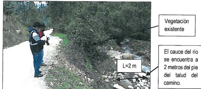
Fuente: Acta de inspección física n.° 001-2021-CG/OCI-SCE-MPY de 25 de octubre de 2021.
